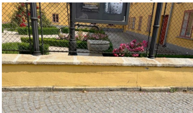
Obr. 2. Detail poškození omítek, zídka pod kovaným oplocením, přiloženo k žádosti.
