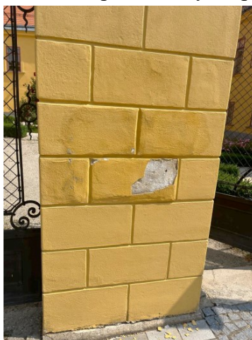
Obr. 3. Detail poškození omítek, pilíř kované brány, přiloženo k žádosti.
