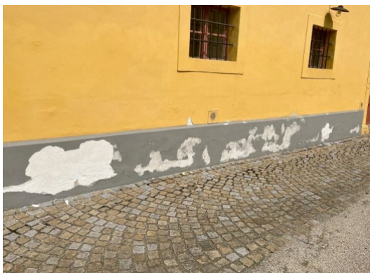
Obr. 1. Detail poškození omítek, čestný dvůr, přiloženo k žádosti.
