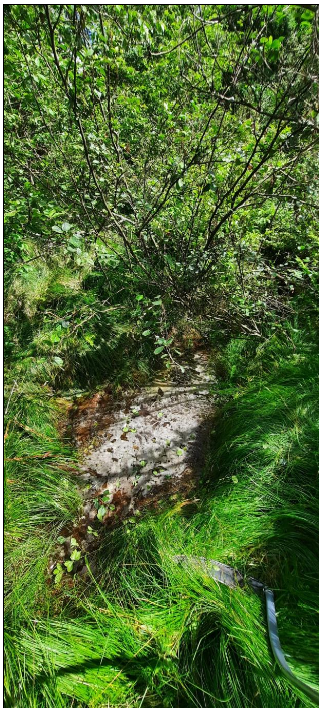
Obrázek 3 - Průsak v podhrází.
