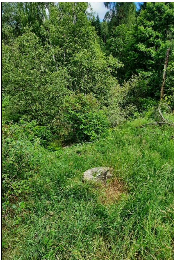
Obrázek 2 - Pohled do podhrází – průsak hrází v místě pařezu po stromu.
