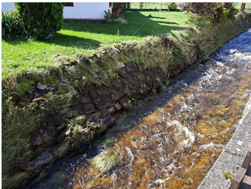
Foto č.3 – úsek rozplavené patky
