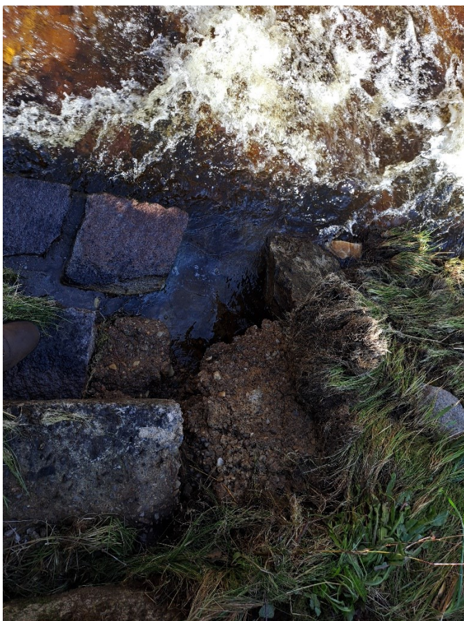
Foto č. 1,2 – drobné kaverny v opevnění
