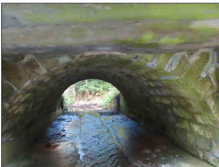
Pohled zleva Původní část - u paty průsaky
