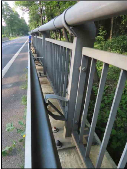
Pravá strana Zábradelní svodidlo - deformace od nárazu
