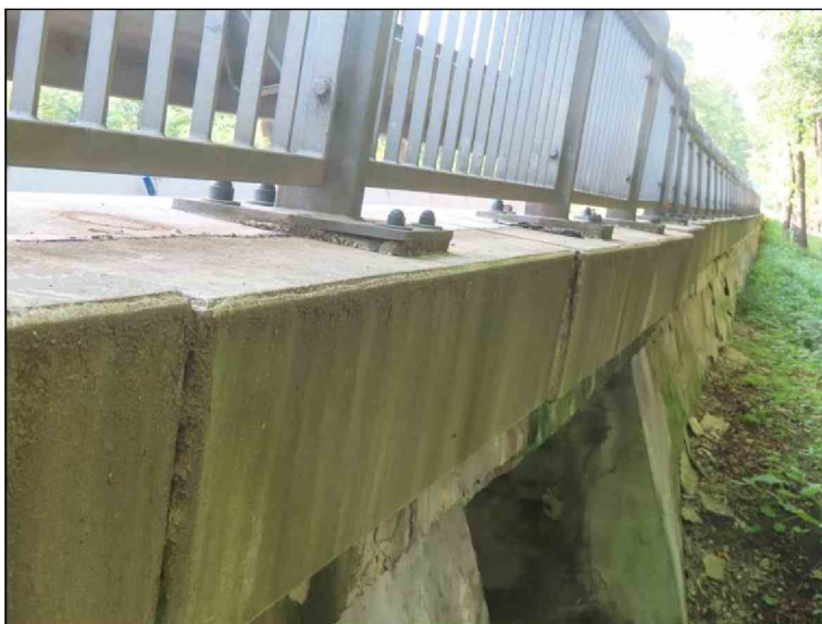
Pohled na most zprava od OP1 Vykloněná římsa
