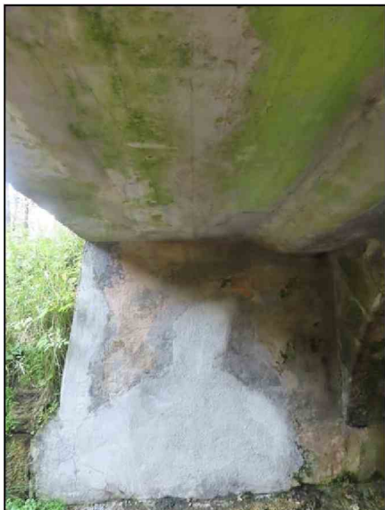
Pohled na OP2 zleva Sanace- u paty trhliny
