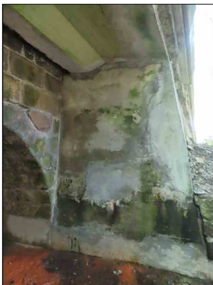
Pohled na OP2 zprava Zavlhlý líc
