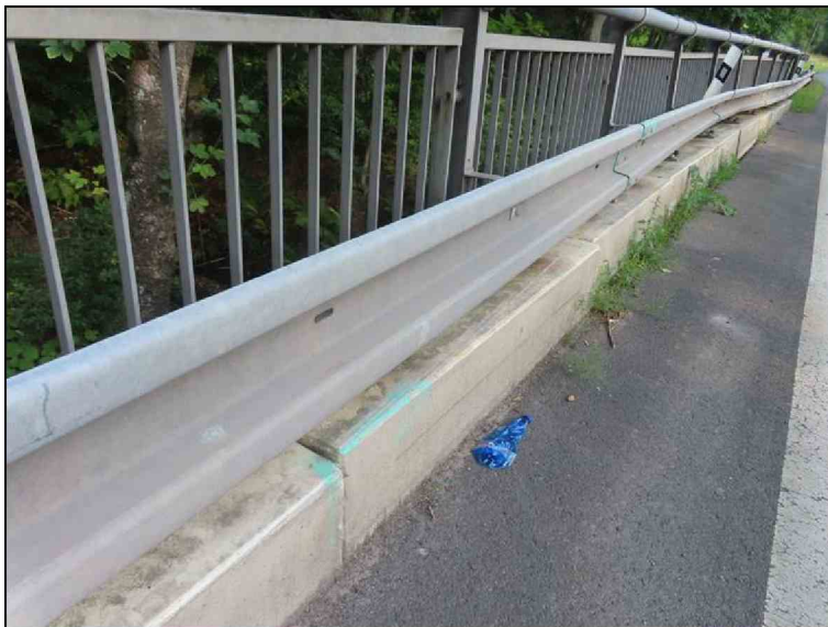
Pravá strana nad OP1 Římsa - vyklonění a posun vnějším směrem
