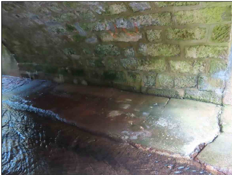
Pohled směrem k OP1 zleva Původní část - u paty průsaky
