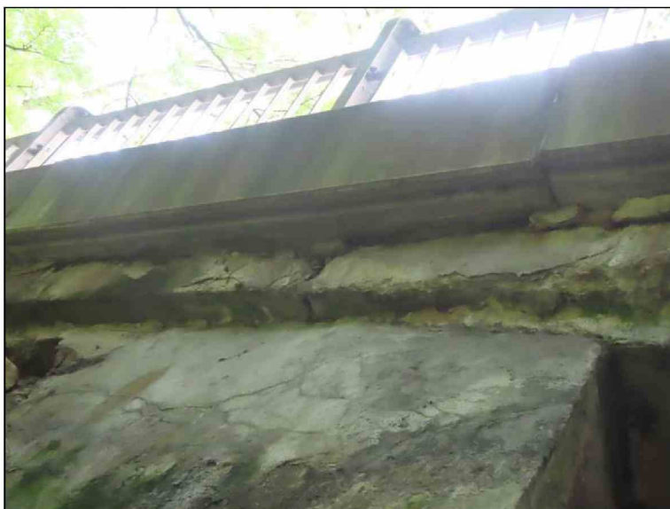
Pohled na OP1 a křídlo zprava Rozpad betonu
