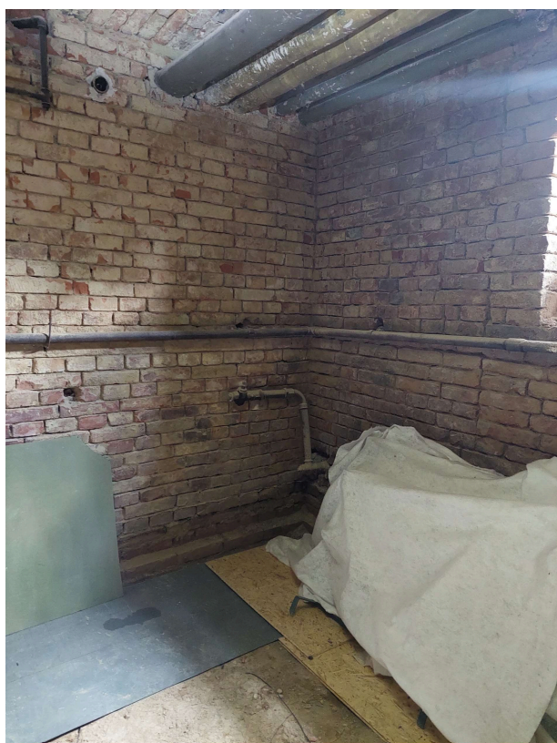
Obvodové zdivo ulice Zahradníková – přestup vlhkosti do střední stěny
