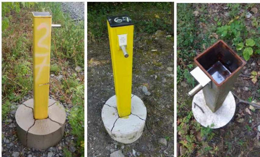
Obrázek 19 Popraskané betonové základy zajišťovacích značek ŽPSV
