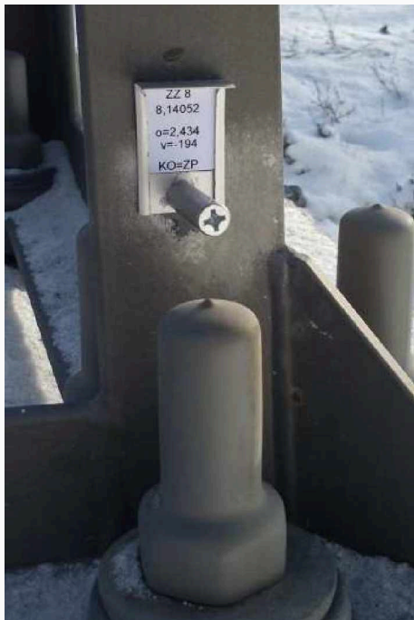
Obrázek 9 Konzolová značka na podpěře trakčního vedení
