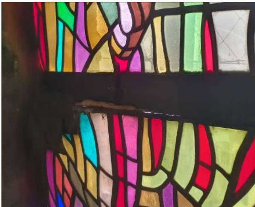
Výplň č. 4 – důsledek hroucení se vitráže vlastní vahou – „vyklouznutí“ zpoza krycí lišty kovového příčnicku
