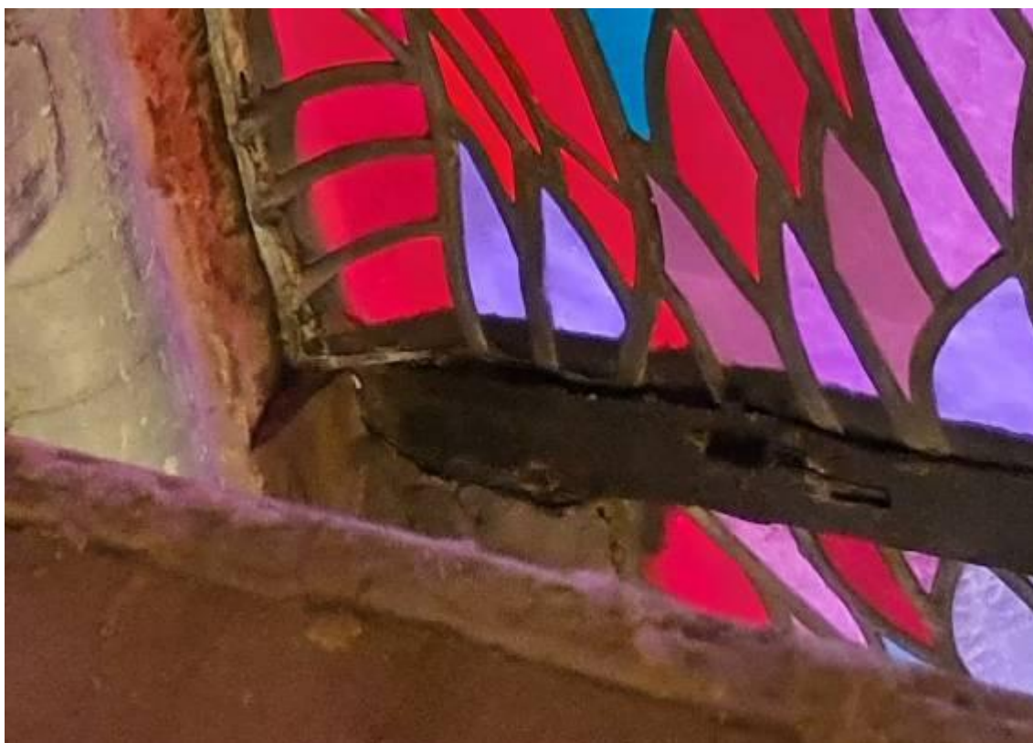
Výplň č. 1 – důsledek hroucení se vitráže vlastní vahou – „vyklouznutí“ zpoza krycí lišty kovového příčnicku
