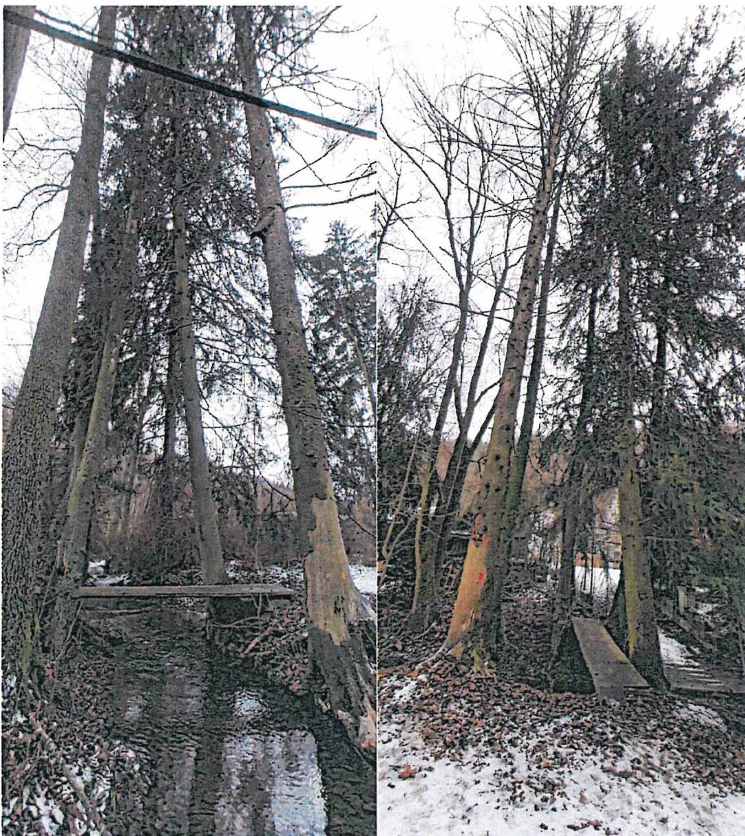
Foto č. 3, 4: Pohled na skupinu stromů k odstranění – rizikové kácení poblíž el.vedení
