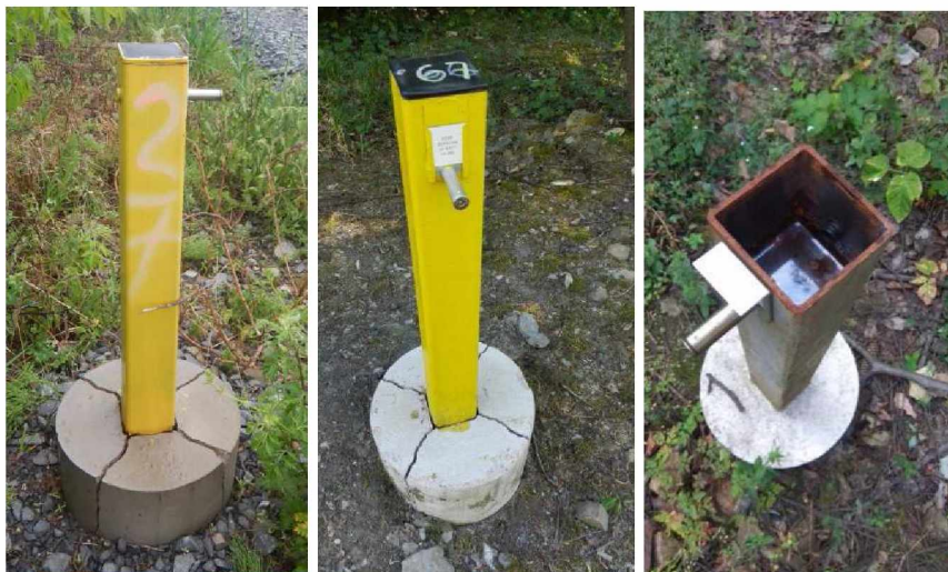
Obrázek 19 Popraskané betonové základy zajišťovacích značek ŽPSV
