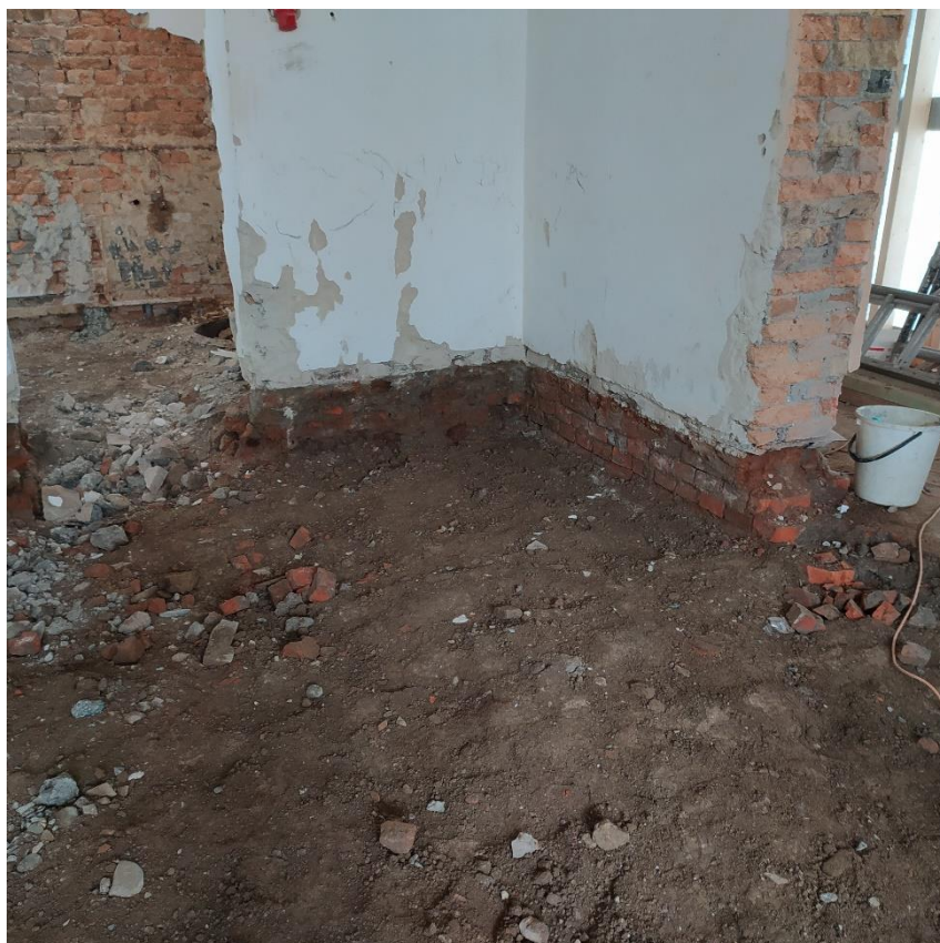
Zavlhhlé zdivo mezi základem a místem podřezání
