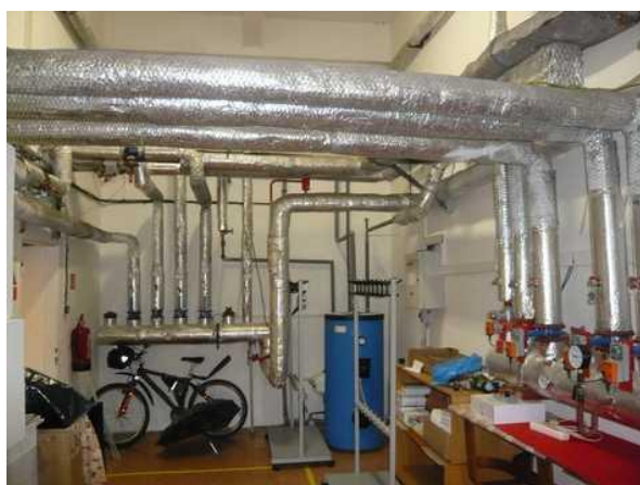
Rozvody sítí ve skladu v 1. NP
