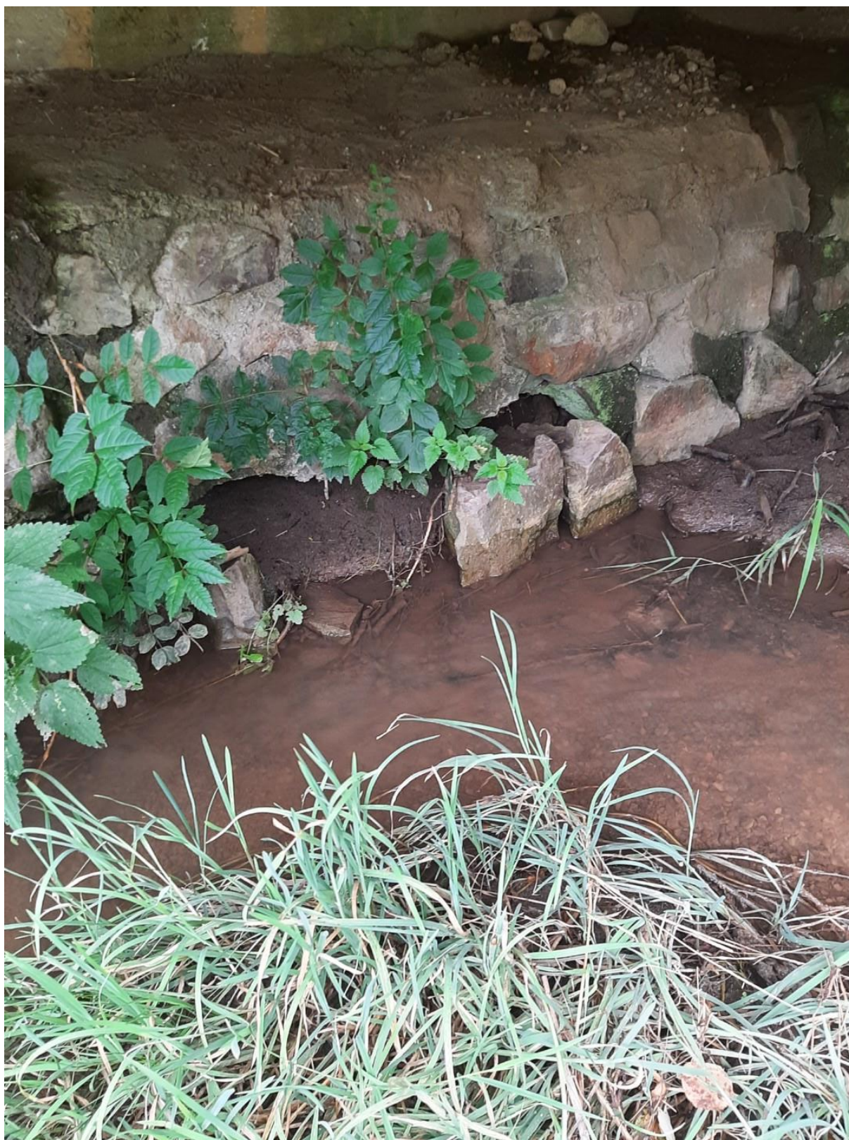
Foto č. 7 – Porušené opevnění pod mostkem
