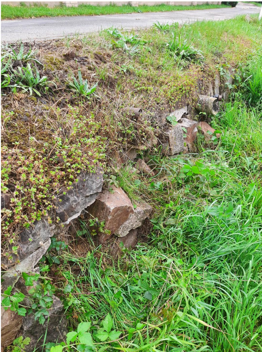
Foto č. 5 – Detail na porušené opevnění ve středním úseku
