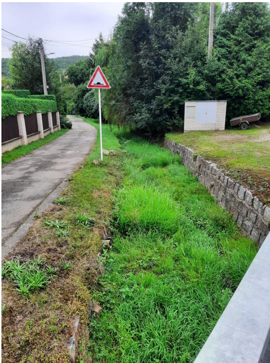
Foto č. 4 – Střední úsek úpravy – na levém břehu silně porušené opevnění
