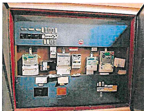
Obr. stávající rozvodná skříň
