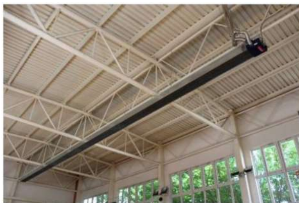
Plynový zářič - tělocvična
