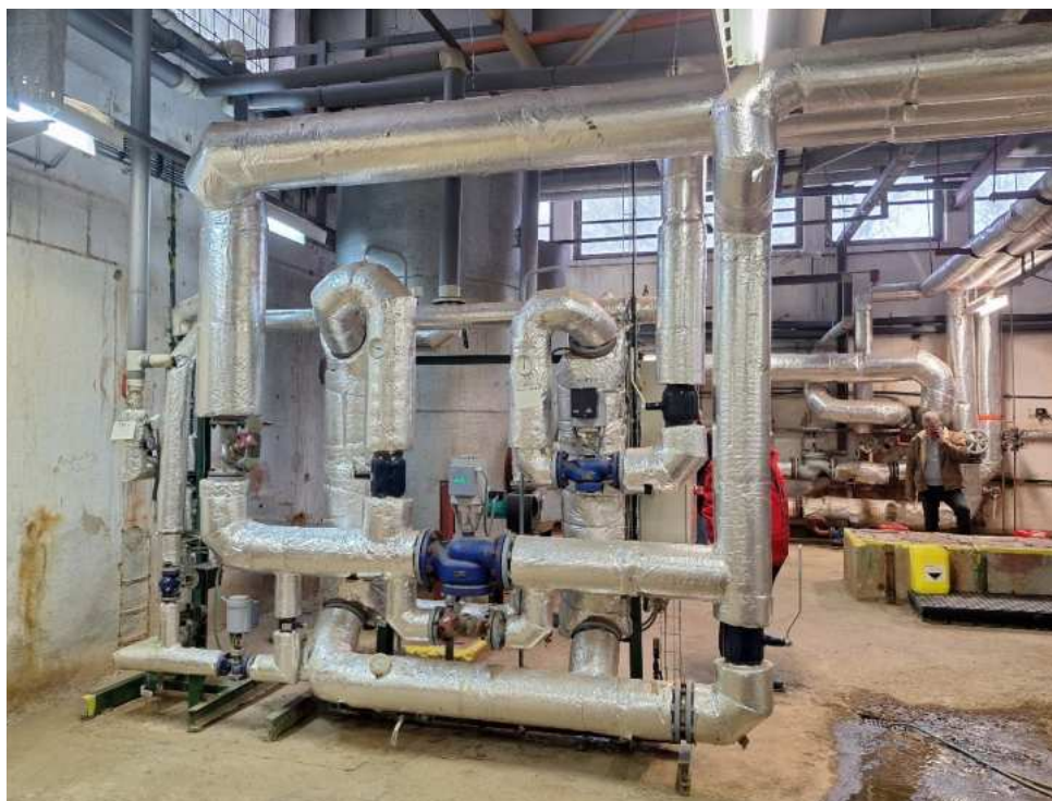
Obr. č. 1.1.5h – Výměník TUV (pavilon D')
