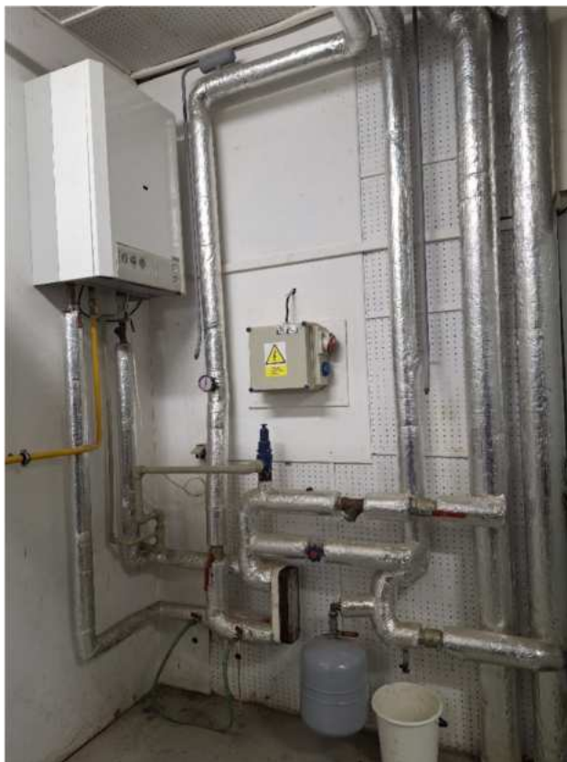
Obr. č. 1.1.3e – Teplovodní výměník + plynový kotel
