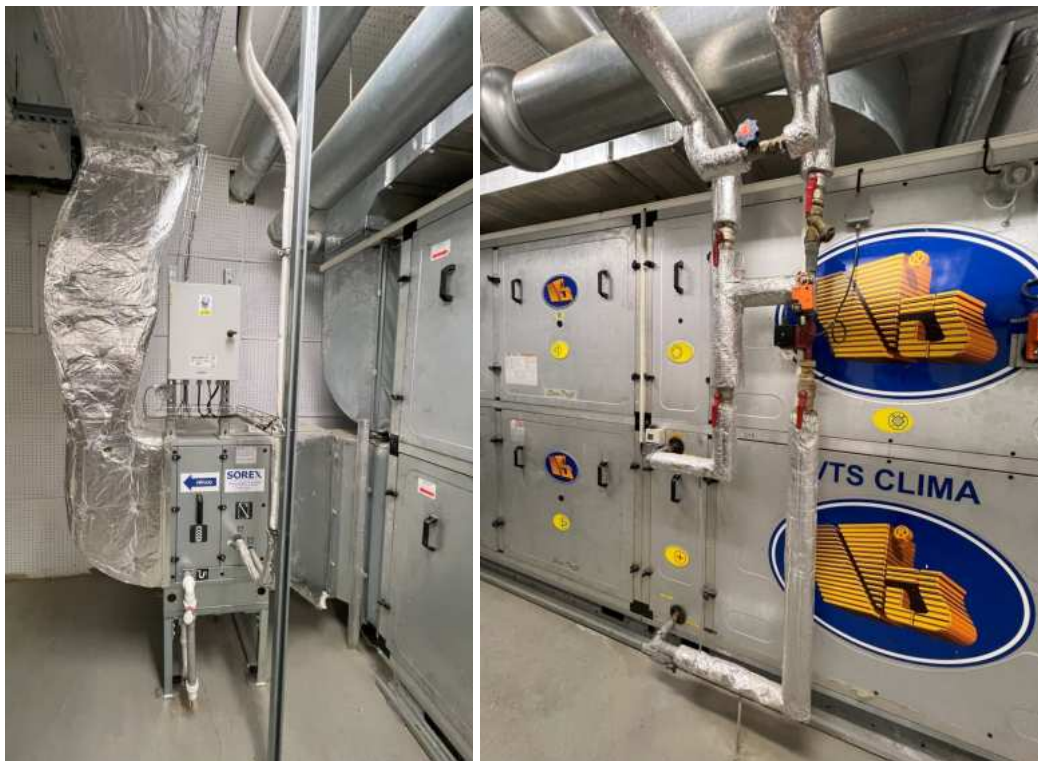
Obr. č. 1.1.3d – VZT jednotka
