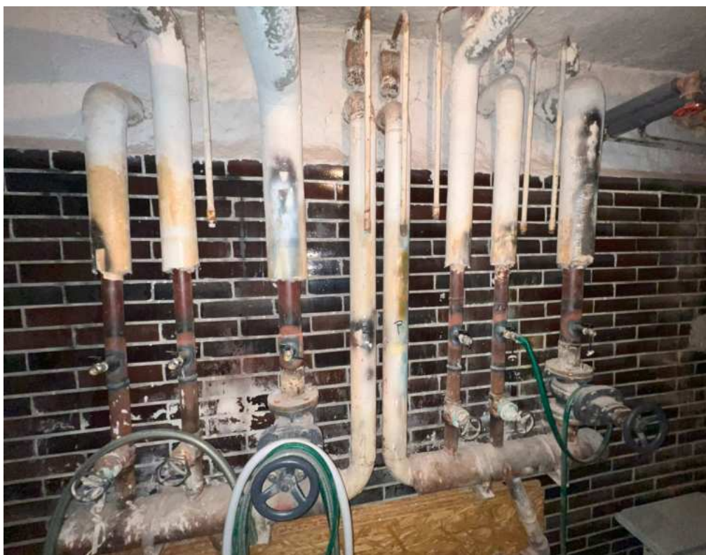
Obr. č. 1.1.1d – Rozdělovač a sběrač ÚT, pavilon B
