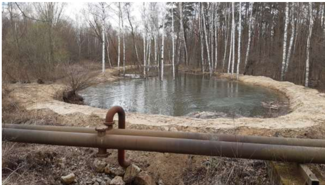
Obr. 3: Pohled na místo vyústění potrubí v době, kdy probíhá napouštění. V době realizace zemního valu (zemní val nyní již zarostlý vegetací)
