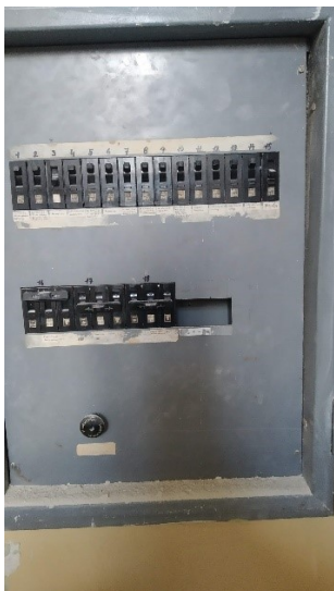
Obrázek 29: Původní rozvodové skříň
