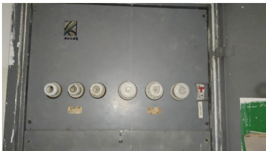
Obrázek 32: Původní rozvodové skříň
