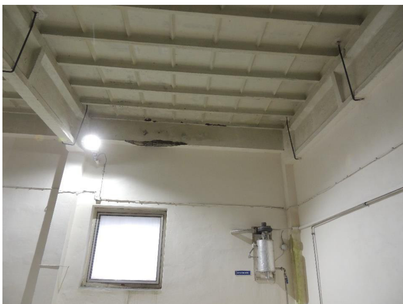
Pohled na část konstrukcí s největšími poruchami od korodující výztuže
