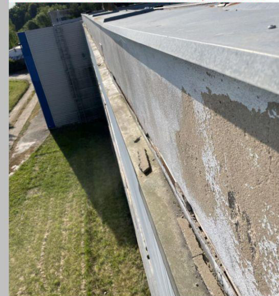
FASÁDA SEVER - POŠKOZENÍ OMÍTKY ATIKY, OPLECHOVÁNÍ
