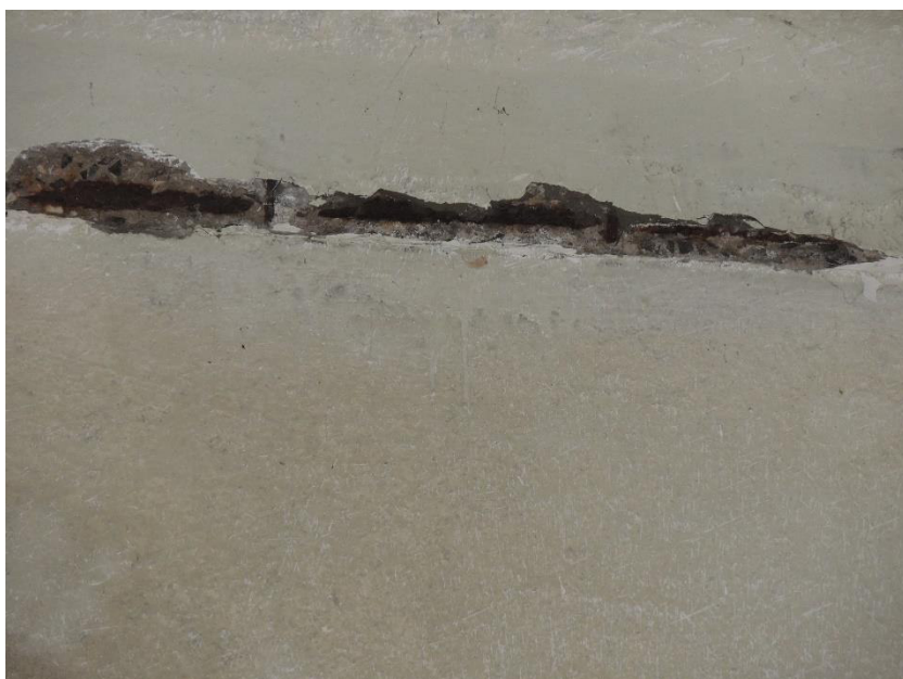
Detail místa poruchy od korodující výztuže obvodového žebra prefabrikované střešní desky
