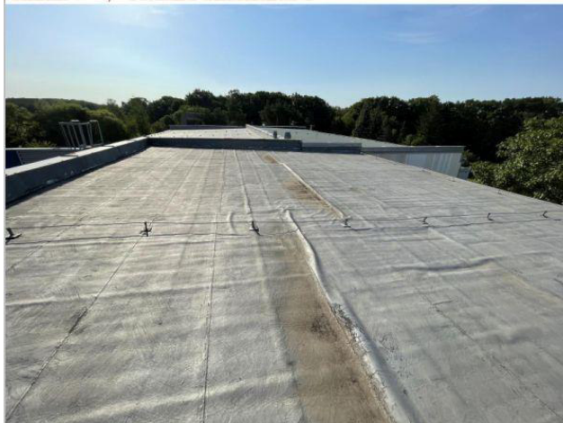
STŘECHA 7 , ZVRÁSNĚNÍ HYDROIZOLACE 2
