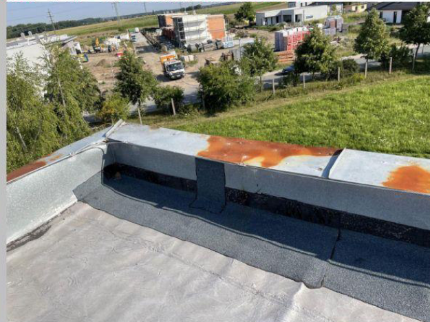
ATIKA SZ ROH - LOKÁLNÍ OPRAVY , NEVÝHOVUJÍCÍ OPLECHOVÁNÍ
