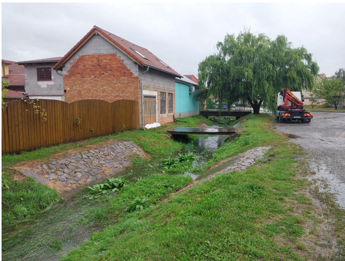
Obr. č. 6: Úsek 2, ř. km 3,2, pohled po proudu, velmi malý podélný profil vlivem zanesení
