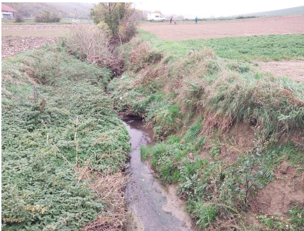
Obr. č. 1: Začátek úseku 1, již mimo intravilán, zde počítáno v rámci odstranění sedimentu s napojením na původní niveletu, na PB viditelná nátrž, v korytě nálety křovin/dřevin k výřezu
