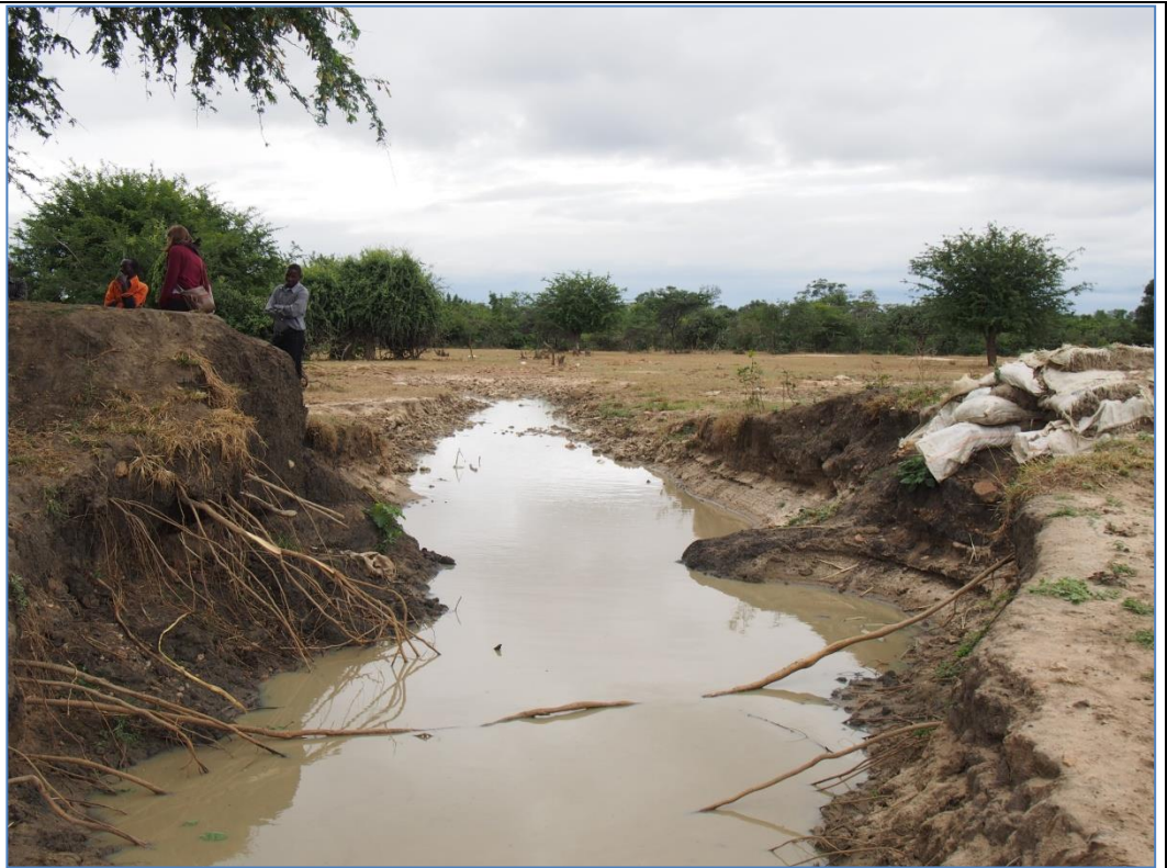
Protržená část hráze
