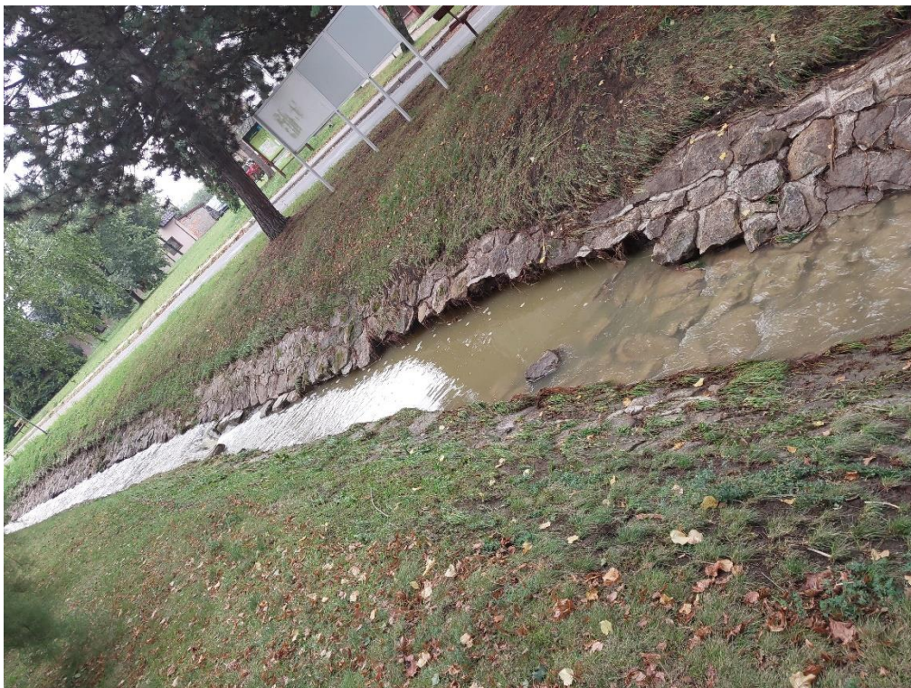
Obr 3 poškozená dlažba a výmol ve dně v ř.km 1,3
