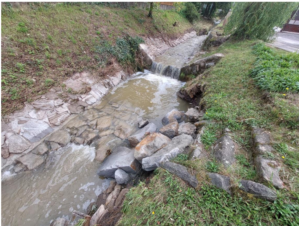
Obr 5 poškozený vývar stupně v ř.km cca 1,74
