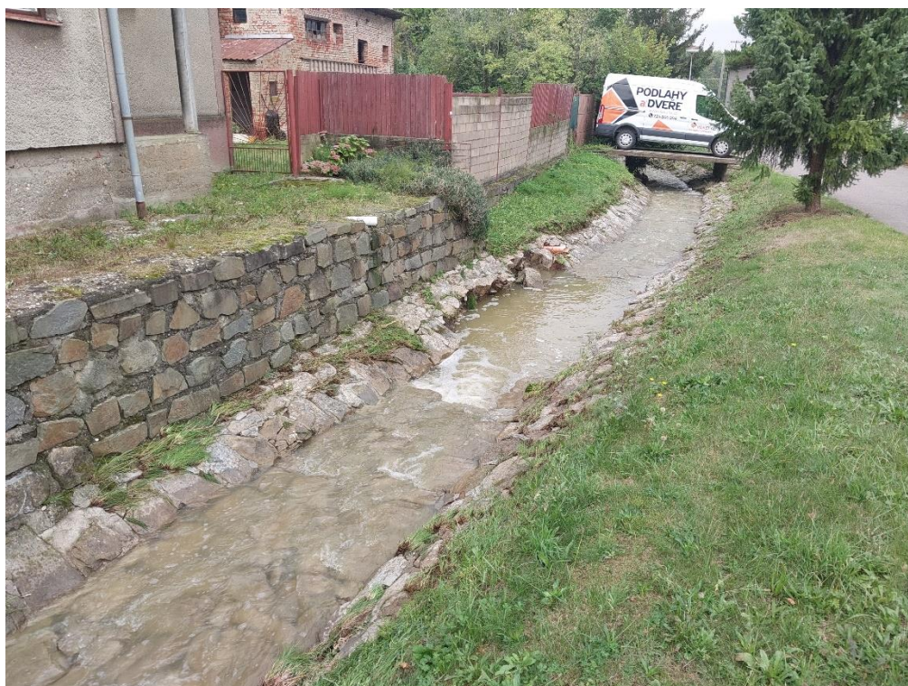
Obr 2 poškozená dlažba a výmol ve dně v ř.km 1,2
