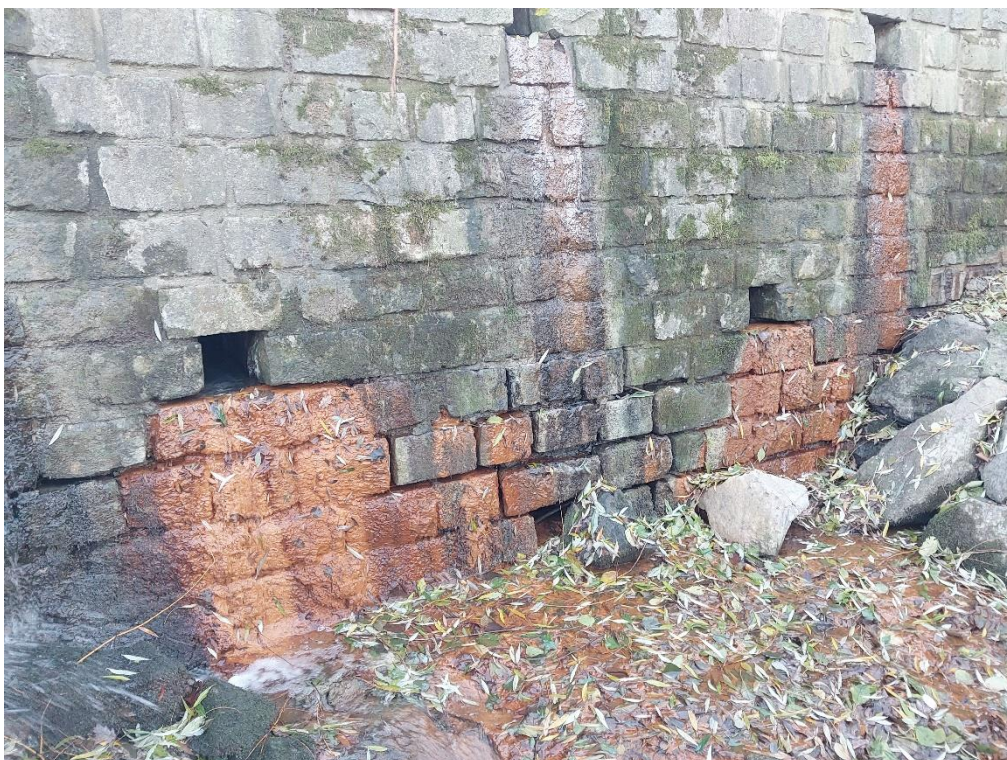
Obr 8 Poškozené spárování na vzdušné straně přehrážky v ř.km 2,2 s neznámým rezavým zabarvením
