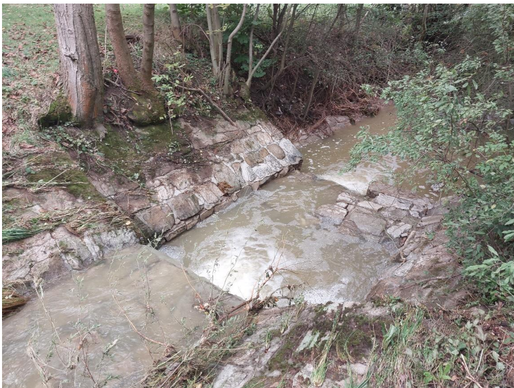
Obr 1 poškozený stupeň v ř.km cca 1,1
