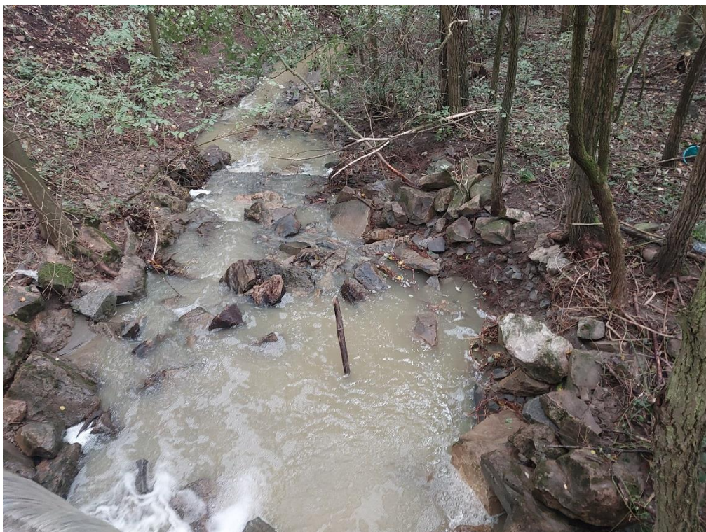
Obr 10 poškozený vývar přehrážky v ř.km 2,43
