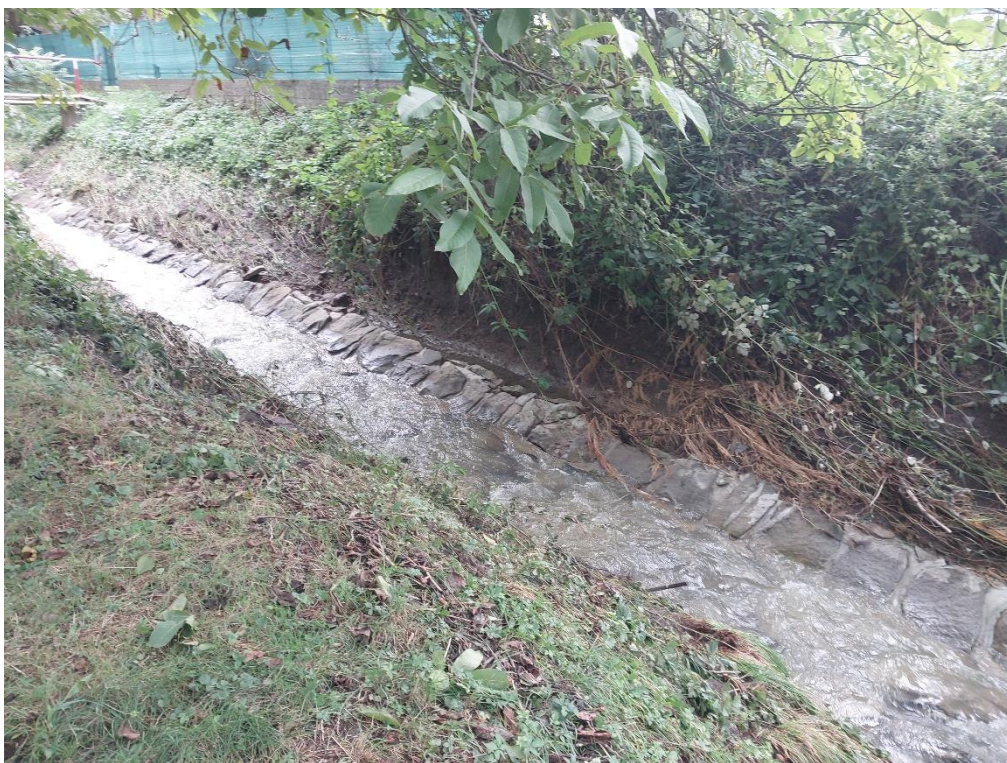
Obr 6 poškozená dlažba v ř.km cca 1,87
