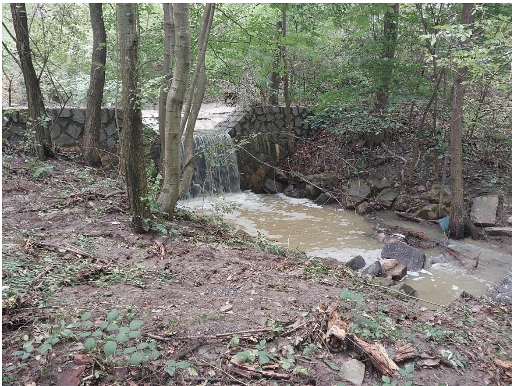
Obr 9 poškozený vývar přehrážky v ř.km 2,34
