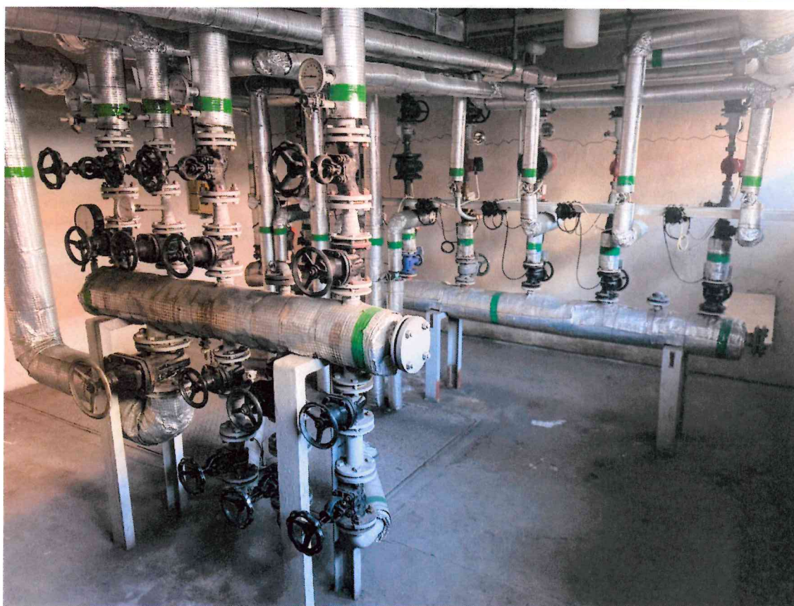
Fotografie stávající technologie kotelny – zadávací dokumentace se netýká této části
