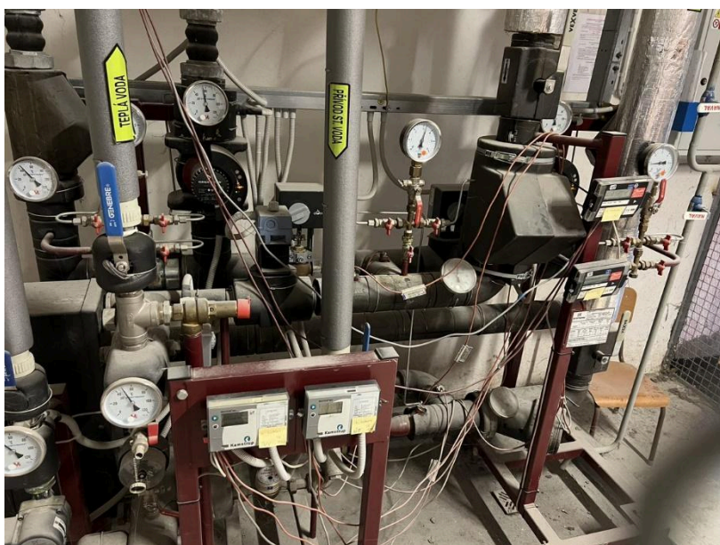
Obr. č. 1.1.6b – Výměňková stanice UT a TUV
