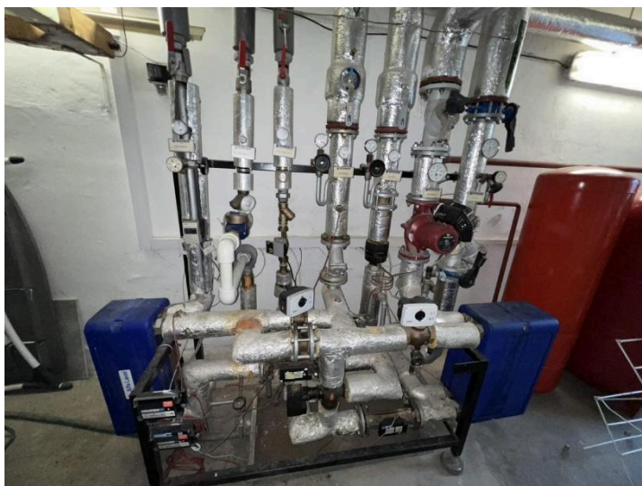
Obr. č. 1.1.11b – Výměníková stanice
