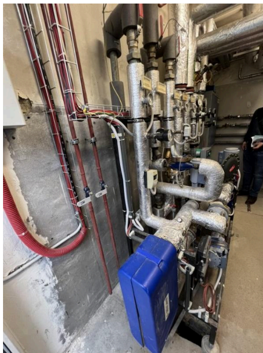
Obr. č. 1.1.8c – Stanice TUV
