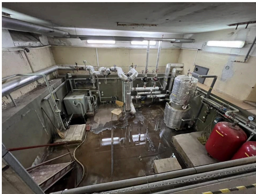
Obr. č. 1.1.12b – Výměňíková stanice
