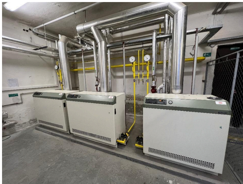
Obr. č. 1.1.2b – Plynová kotelná
