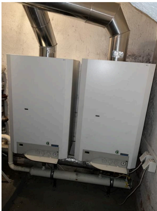
Obr. č. 1.1.5b – Plynová kotelna
