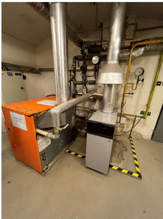
Obr. č. 1.1.4b – Plynová kotelná
