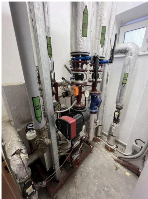
Obr. č. 1.1.10b – Předávací stanice UT a TUV
