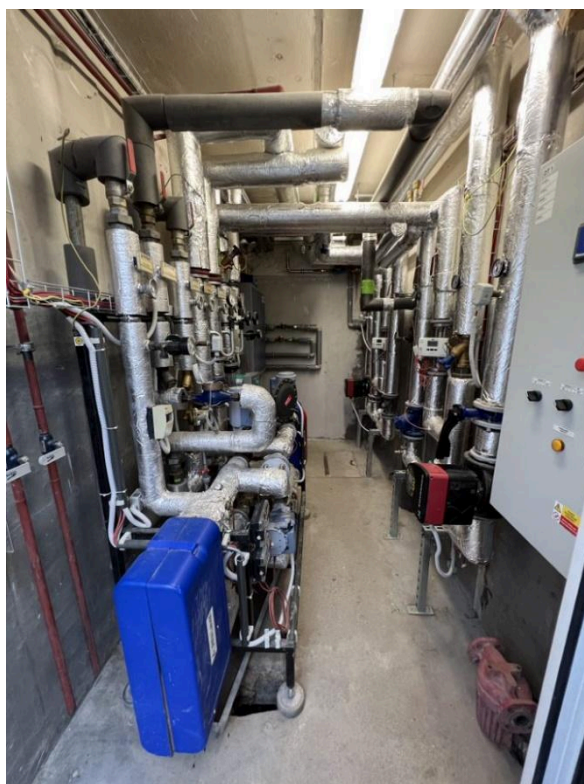
Obr. č. 1.1.8b – Výměňková stanice UT a TUV
