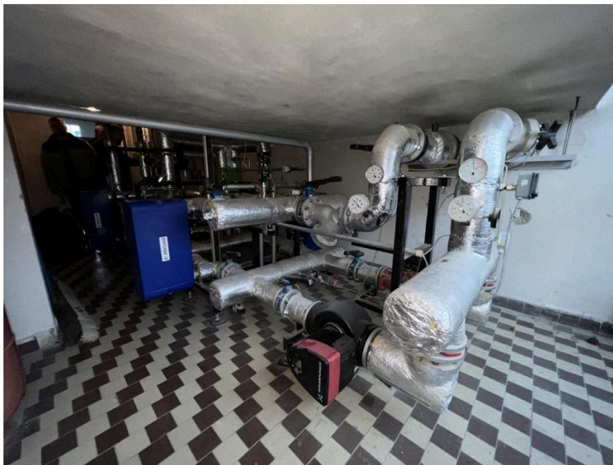
Obr. č. 1.1.7b – Výměňková stanice
