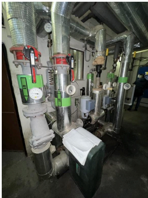
Obr. č. 1.1.9b – Výměňíková stanice UT a TUV
