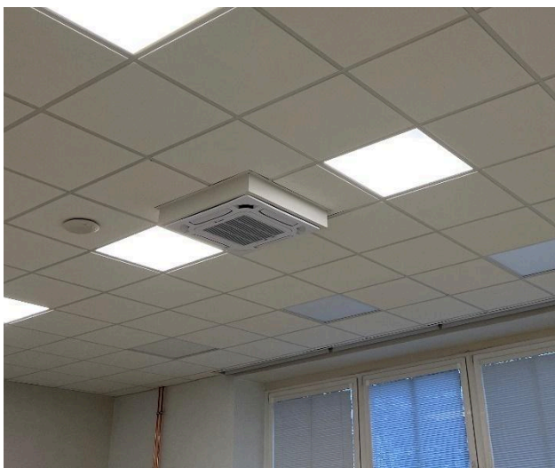
Obr. č. 1.1.2e – Klimatizační jednotka SPLIT
