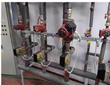
rozdělovač otopné vody ve strojovně VZT (6.NP)
