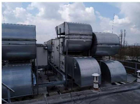
VZT jednotky umístěné na střeše objektu chirurgie
