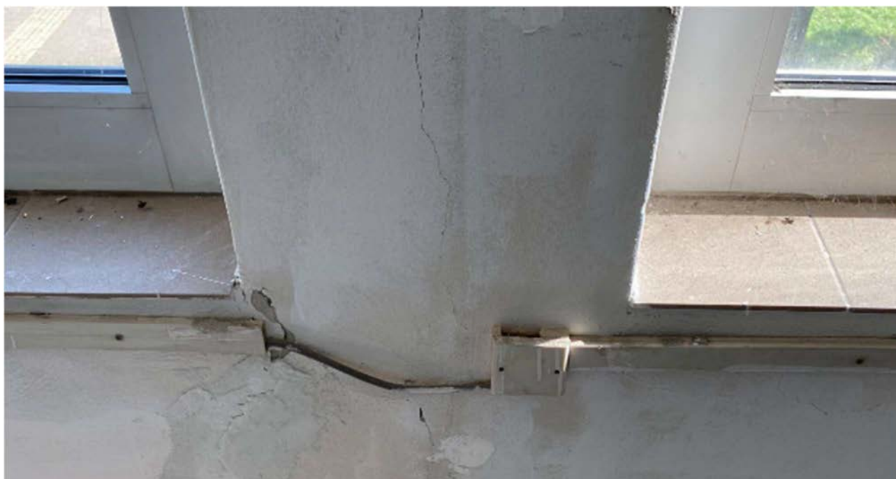
Foto 4) Elektroinstalace v místě dilatace ve 2.NP
