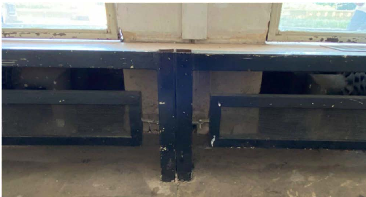
Foto 1) Zakrytí otopných těles v místě dilatace v 1.NP
