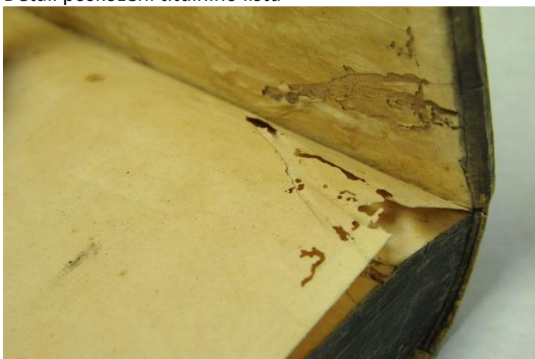
Poškození papíru bloku a předsádek červotočem
