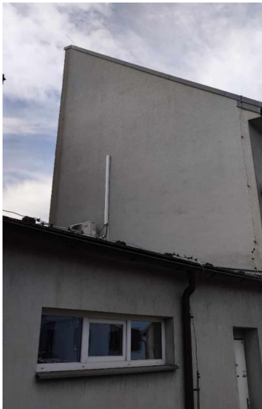
Obr. č. 12 Stěna objektu parc. č. 956/1
