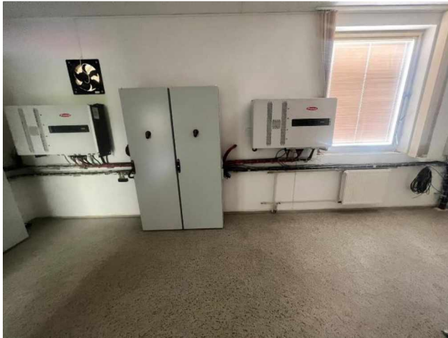
Obr. č. 7 Umístění rozvaděče a střídače
