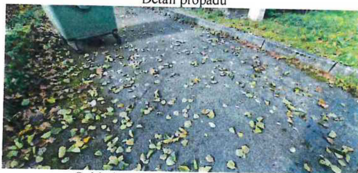
Pohled na čerstvé zátrhy ve vozovce
