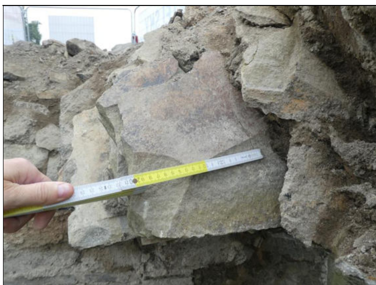
Trhlina v kameni v klenebním pásu 1. pole.
