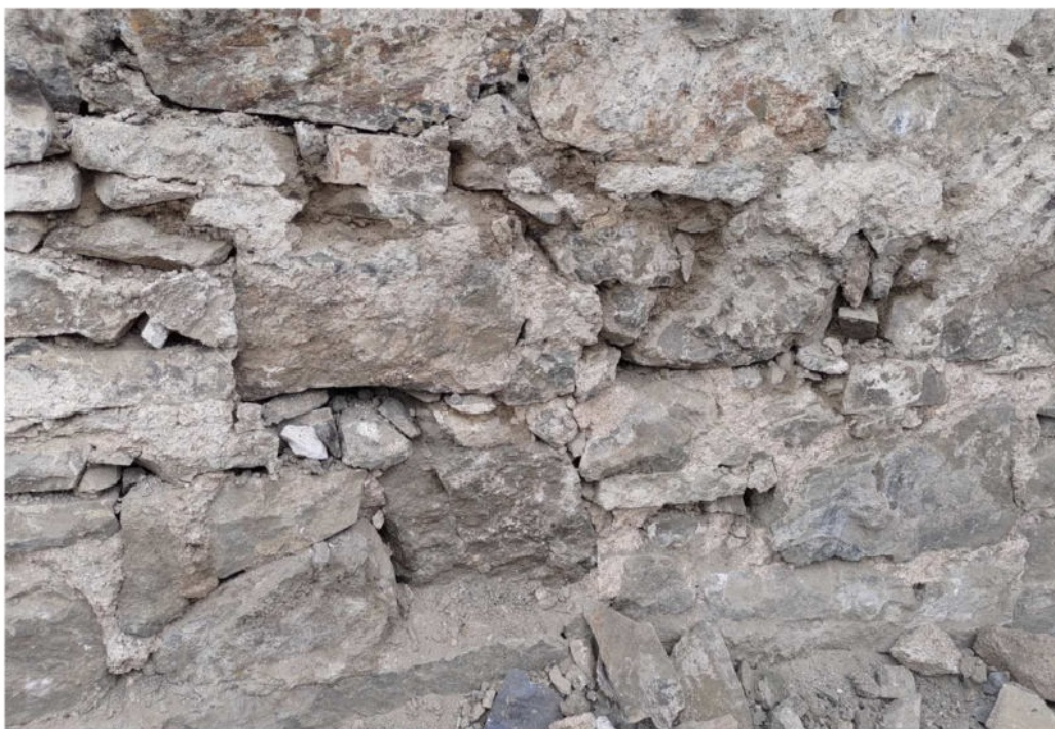
Obr. 6 Povrch zdiva v detailu
