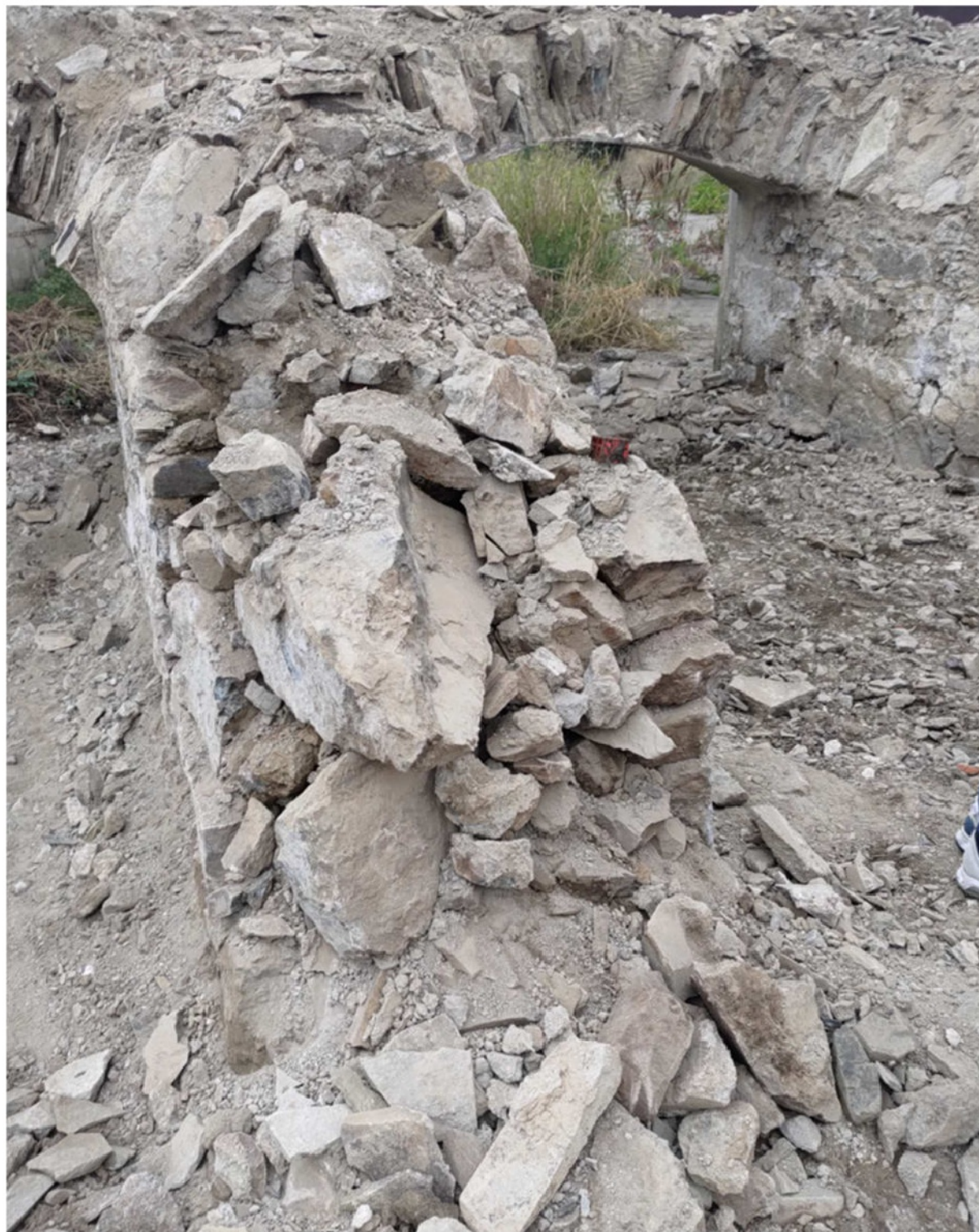
Obr. 4 – rozpadající se zdívo pilíře
