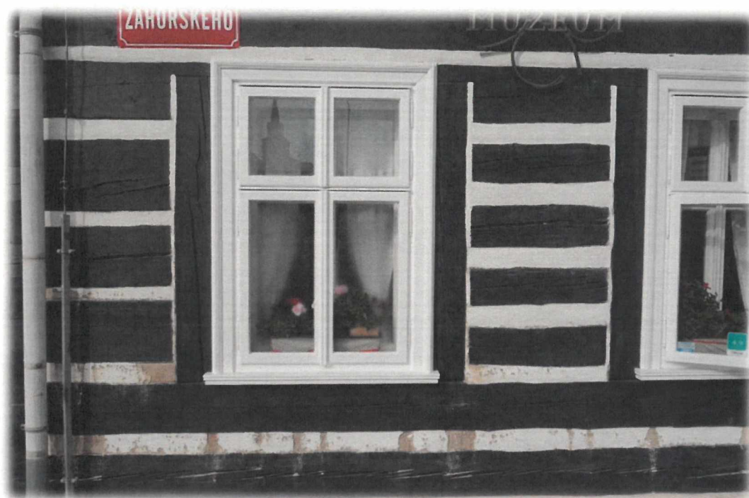
obr. 5: Detail poškození na východní straně.
