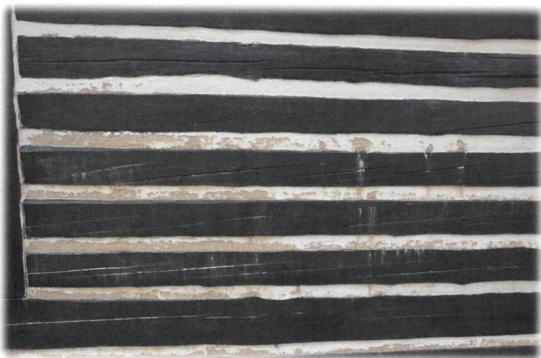
obr. 6: Detail poškození na západní straně.
