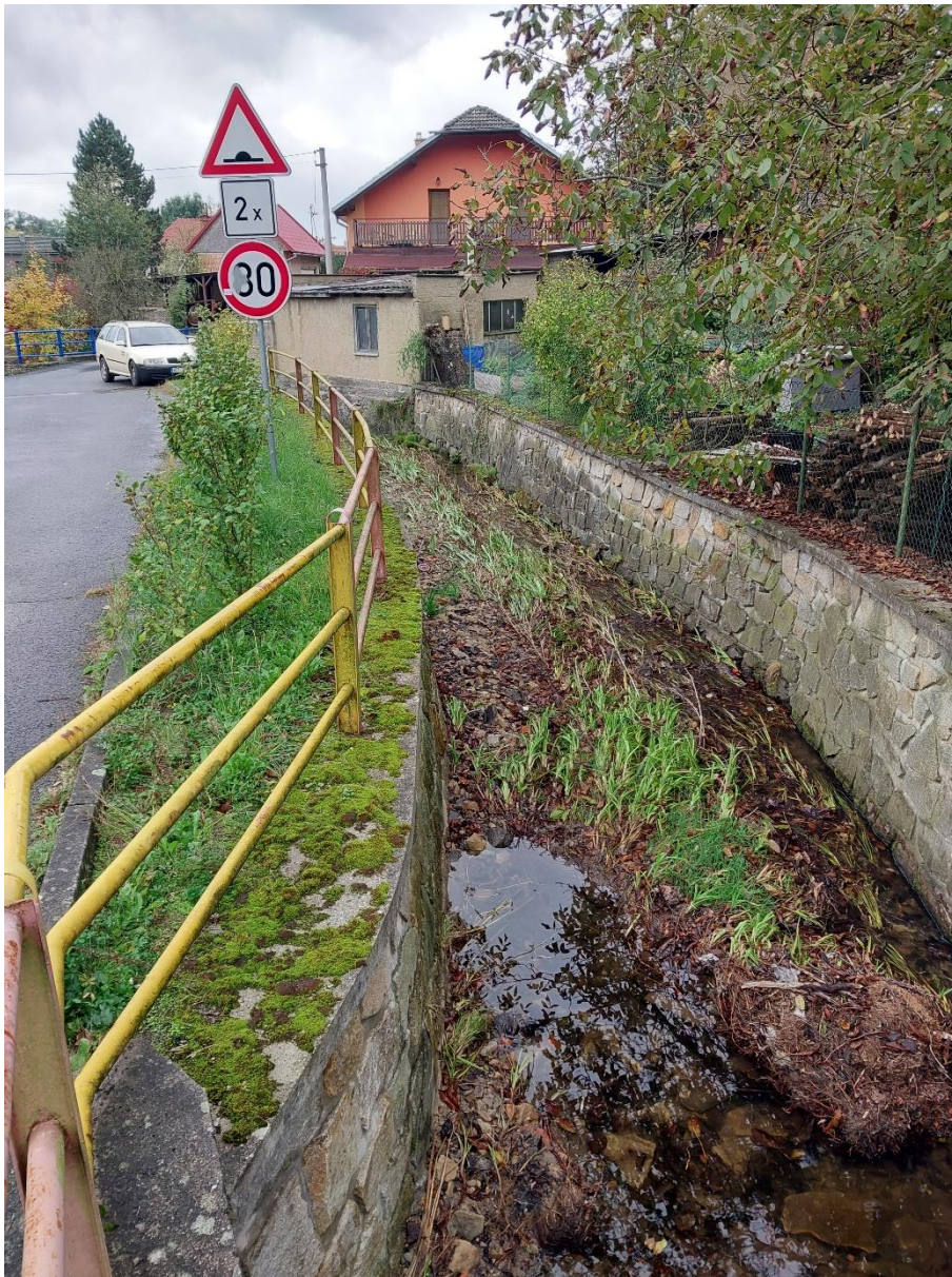
Obr 7 Pohled po proudu v ř.km 3,05. Koryto v oboustranných OZ až po km 2,95, částečně přístupné z místní komunikace. (při provádění nutnost objíždky). Níže po toku je koryto nepřístupné.
