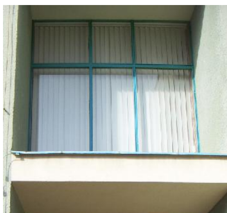
Vnější stěna v úrovni 2.NP (2x)
