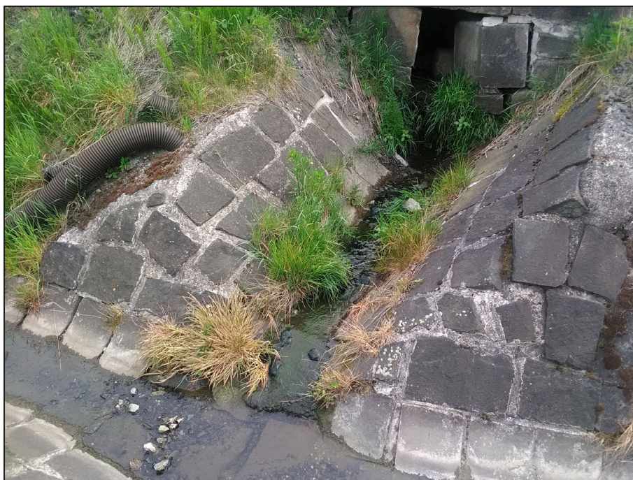
Obrázek 1 Vyústění vodoteče do příkopu vpravo v km cca 303,500
