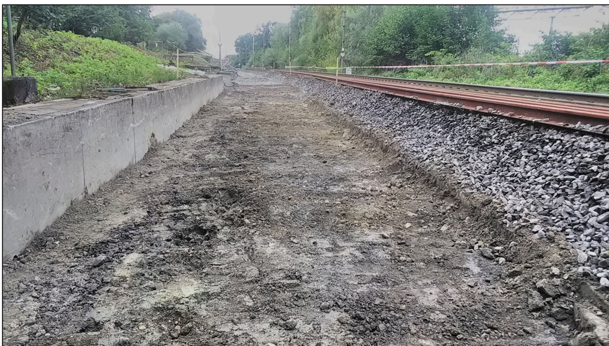
Obrázek 4 Poškozená vrstva zemin upravených vápnem a cementem v km 283,200 v koleji č. 1 úseku Bohumín – Dětmarovice po jejím odkrytí (stav 31.8.2020)
