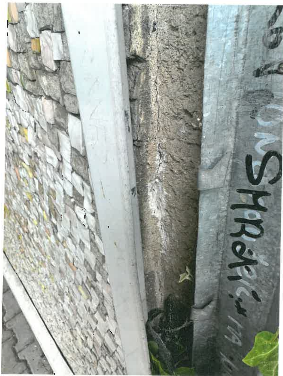
Pohled na spodní pravou stranu mozaiky - viditelné je poškození adjustace oplechováním, pod mozaiku je zeď průčelní fasády.
