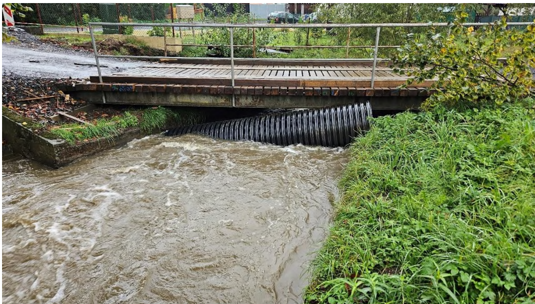
Přetržená trouba, která uvízla pod provizoriem
