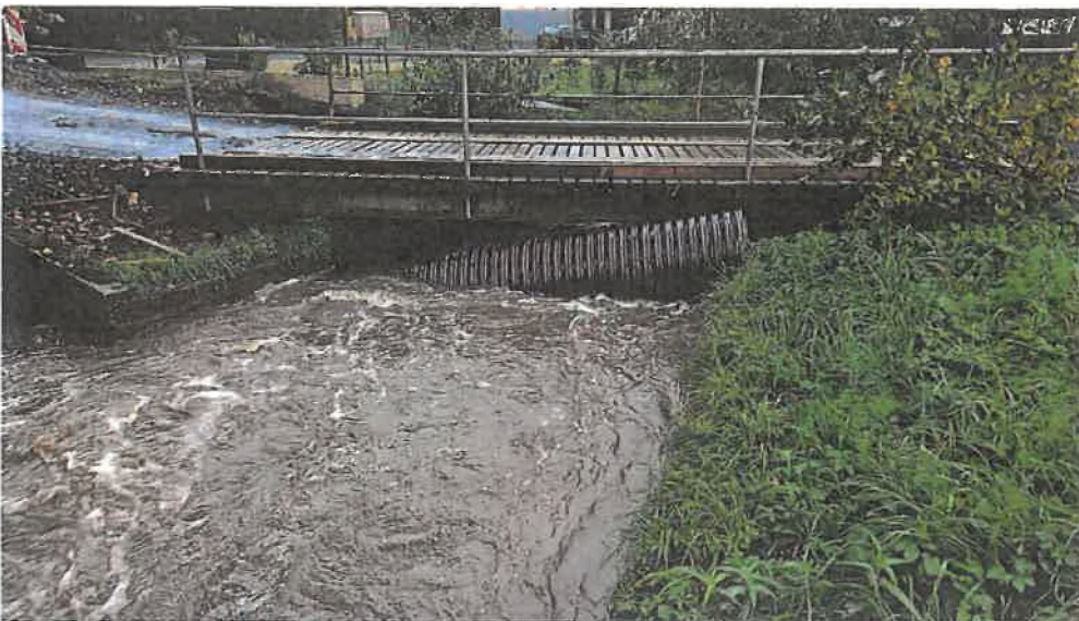
Přetržená trouba, která uvízla pod provizoriem
