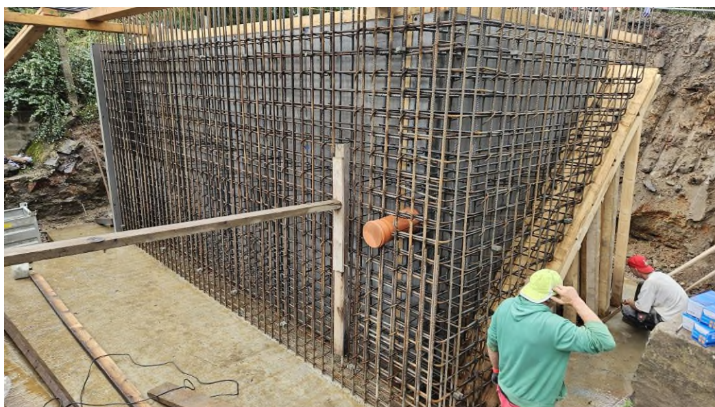
Vyarmovaná opěra 1 před povodní.
