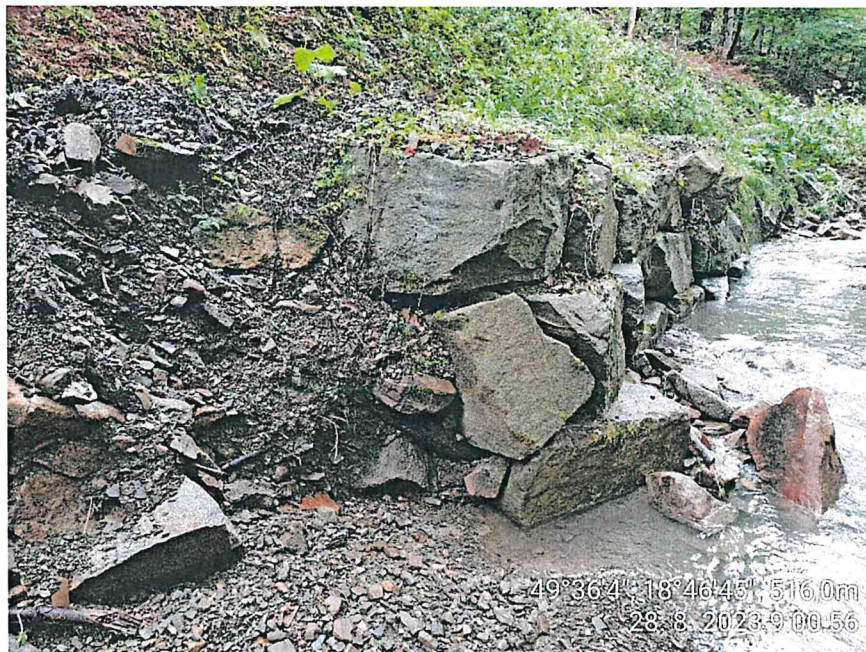
Narušená kamenná rovnanina, km cca 2,900
