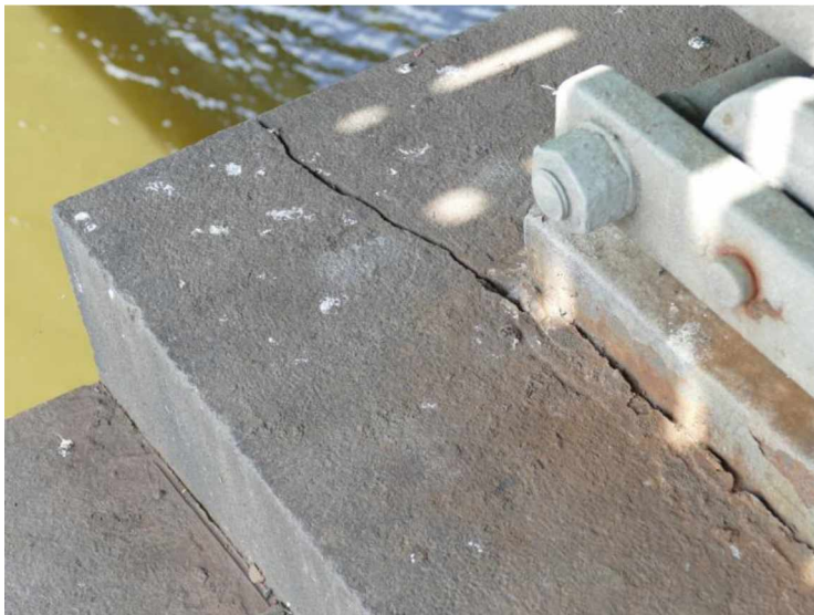
Pilíř P 02 úložný práh: – prasklý kvádr vlevo
