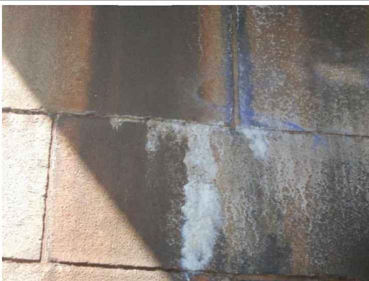
Opěra O 02: – průsaky vody s výluhy pojiva
