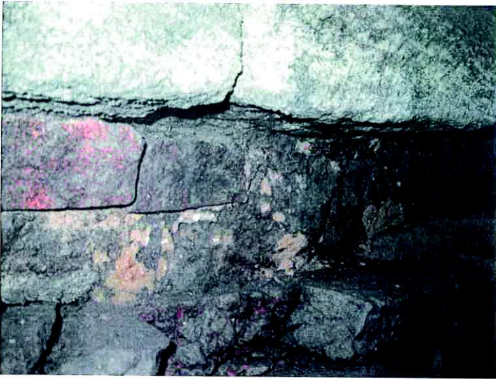
Foto – detail degradace zdiva a pojiva
