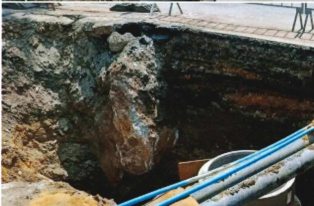
Vylitý betonový blok pod vozovkou
