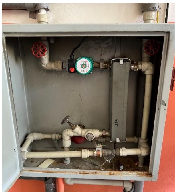
Obr. Výměník přípravy teplé vody
