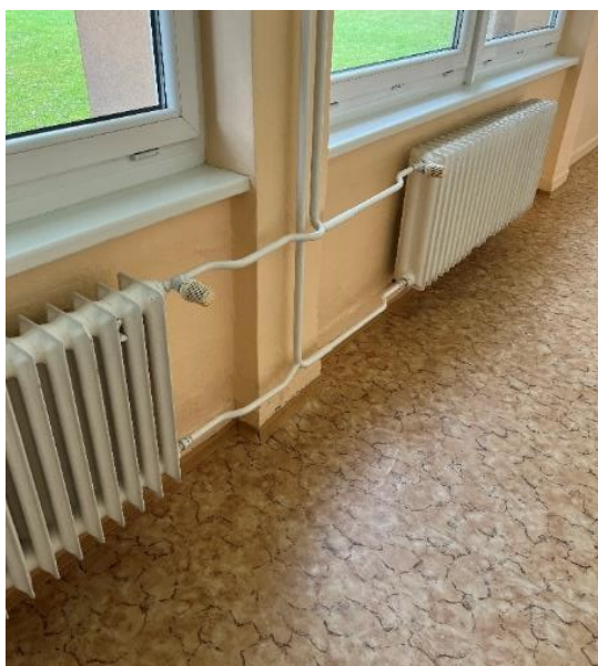
Obr. Detail OT v budově školy
