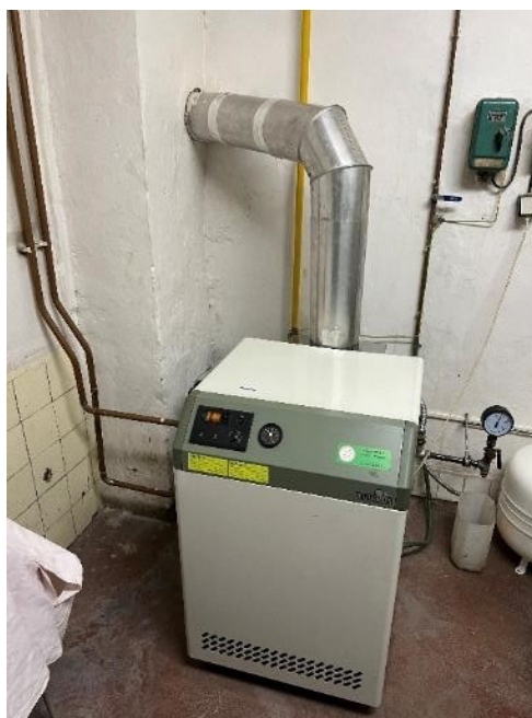
Obr. Zdroj tepla pro budovu Dílen
