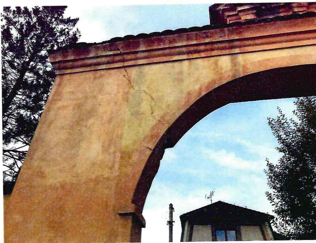
Foto č. 05 – Detail šikmé trhliny v omítce a zdivu brány č. 1 šířky až cca 10 mm
