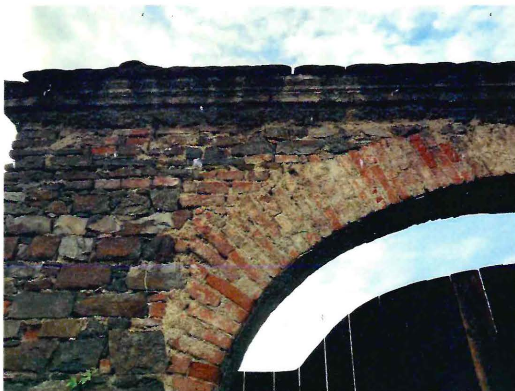
Foto č. 08 – Detail trhliny ve zdivu v levé horní části severní strany brány č.1
