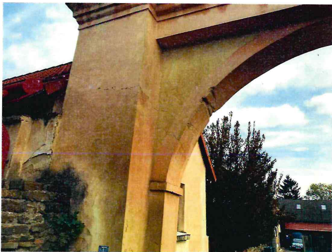
Foto č.02 – vodorovné a šikmé trhliny v omítce v levém pilíři brány č.1
