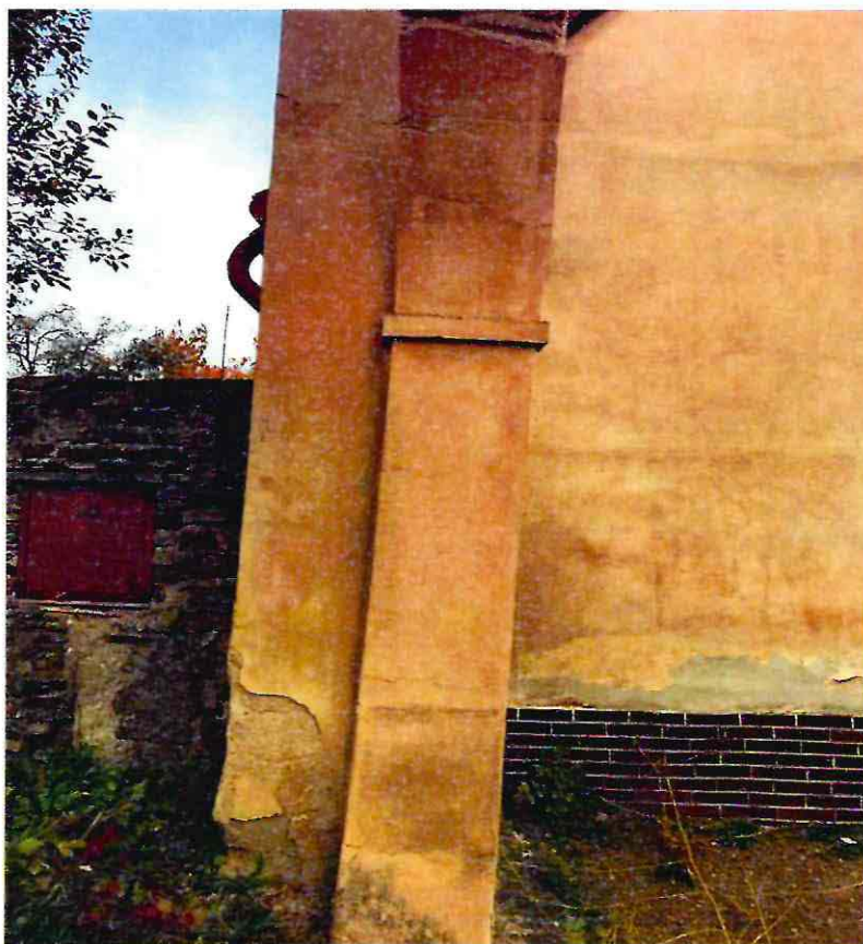
Foto č. 03 – Viditelné svislé vychýlení zdiva brány směrem k východu
