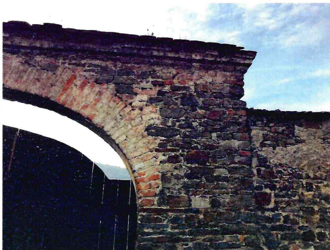
Foto č. 09 – Detail stavu zdiva v pravé části severní strany brány č.2
