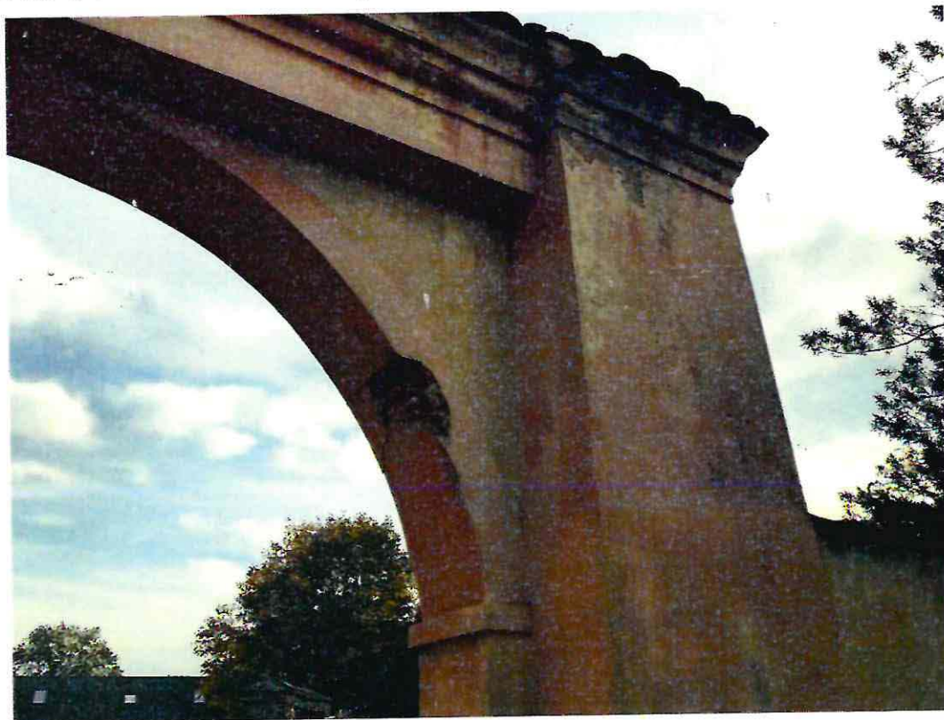
Foto 06 – Mechanické poškození zdiva brány č.1 v klenebném oblouku
