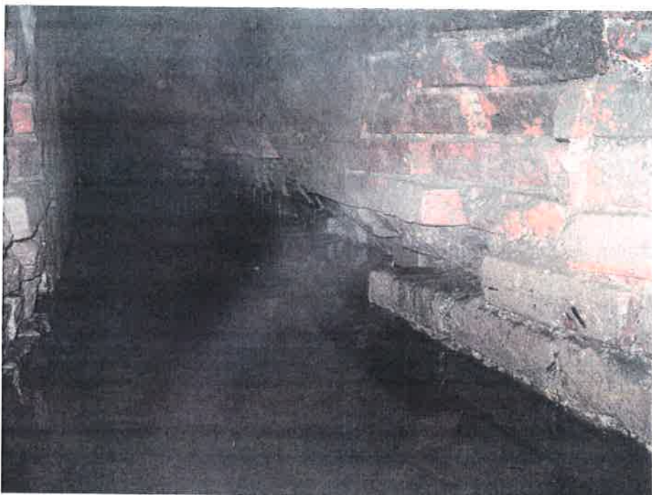
Foto – vypadané kamenné zdivo – kavery v patě zdi
