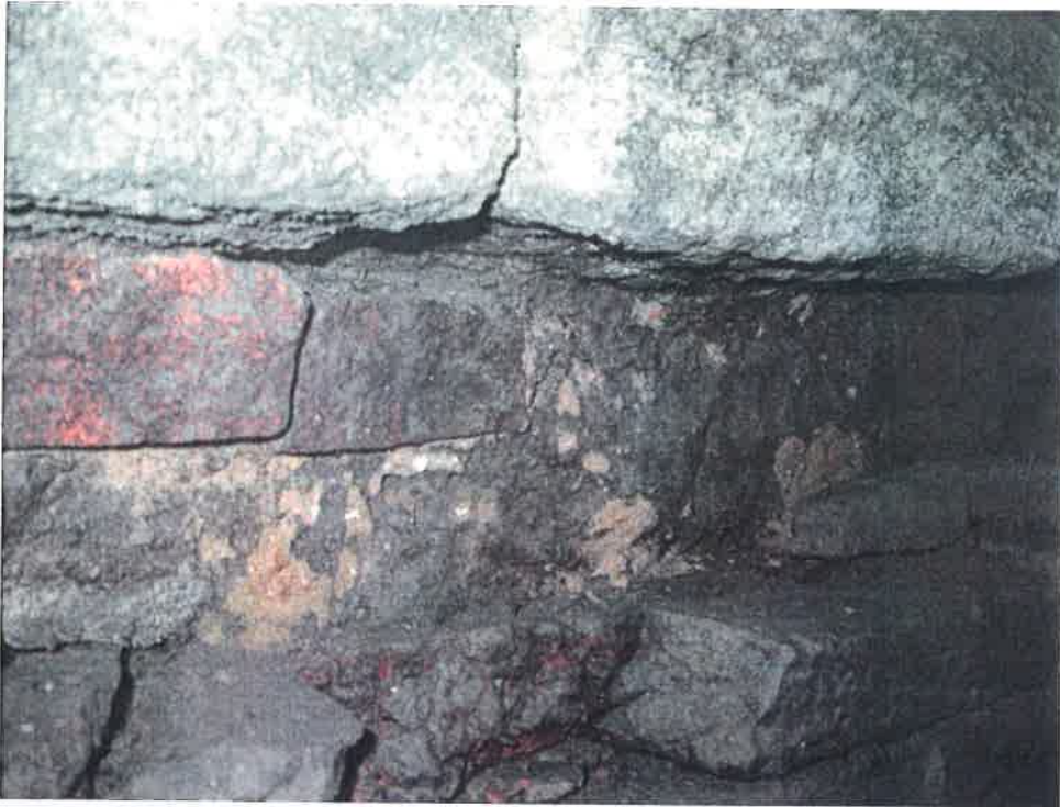
Foto – detail degradace zdiva a pojiva
