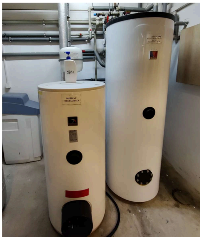
Obr. 33 Zásobníky na teplou vodu
