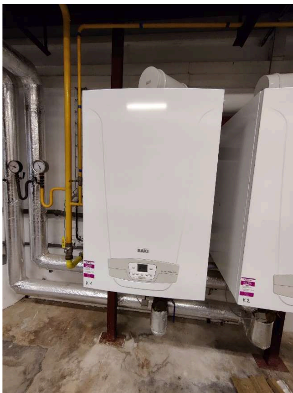
Obr. 30 Kondenzační kotel K1
