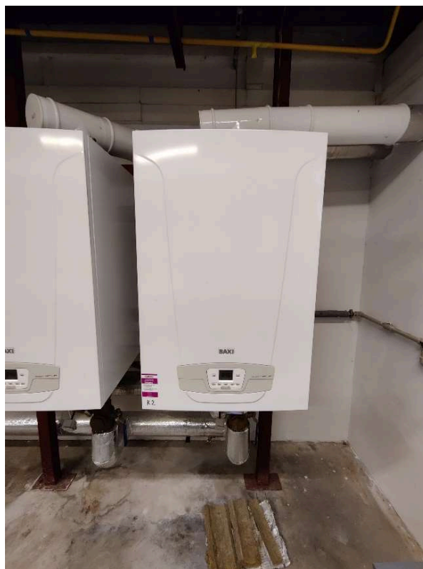
Obr. 31 Kondenzační kotel K2
