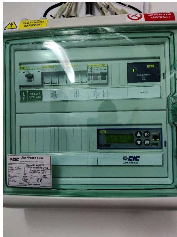
Obr. 44 Rozvaděč MaR VZT
