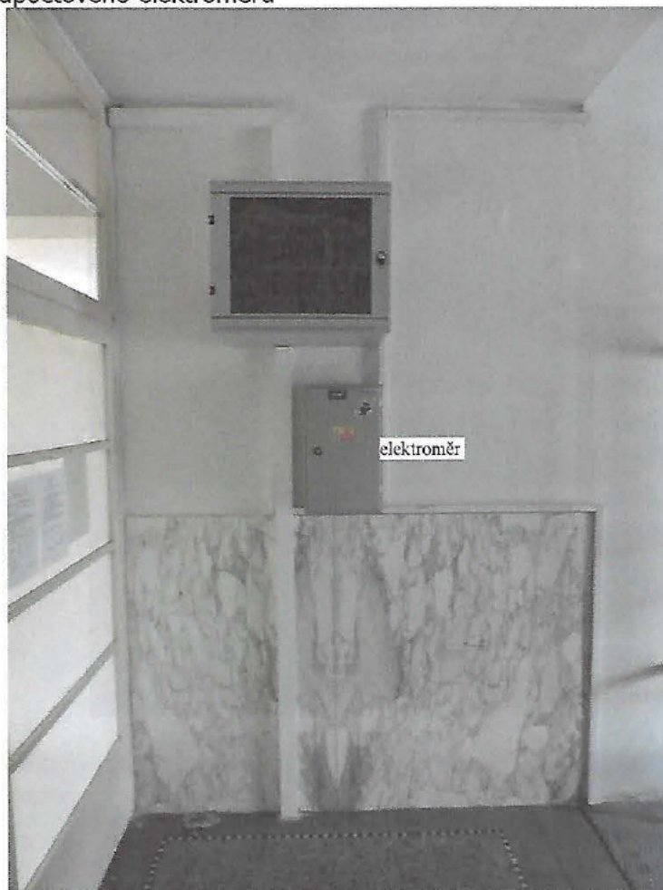
Obr. č.8, Umístění odpočtového elektroměru
