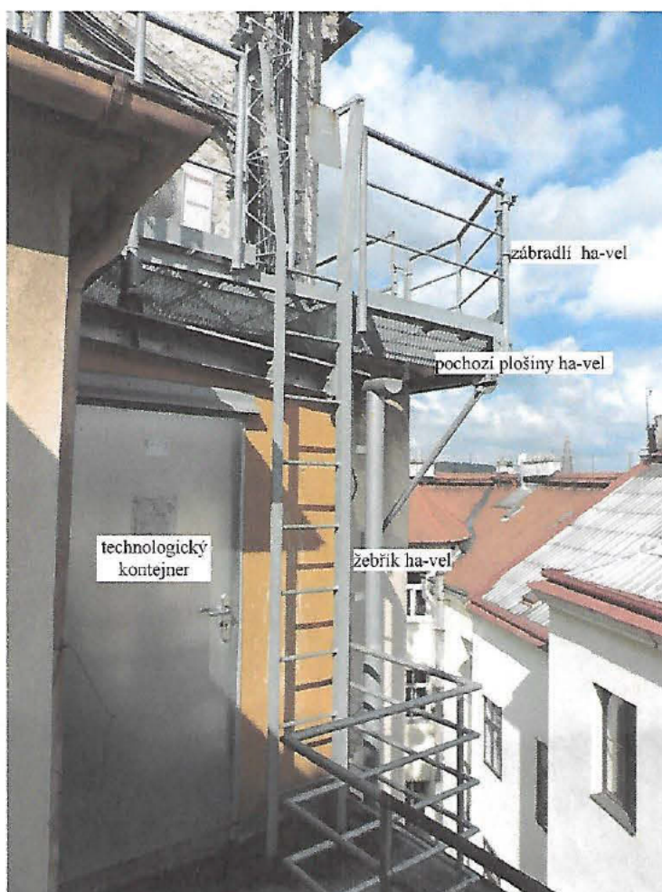
Obr. č.5, Technologický kontejner
