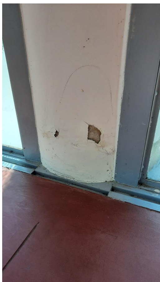
Obr.: Detail poškození vnitřní strana sloupu
