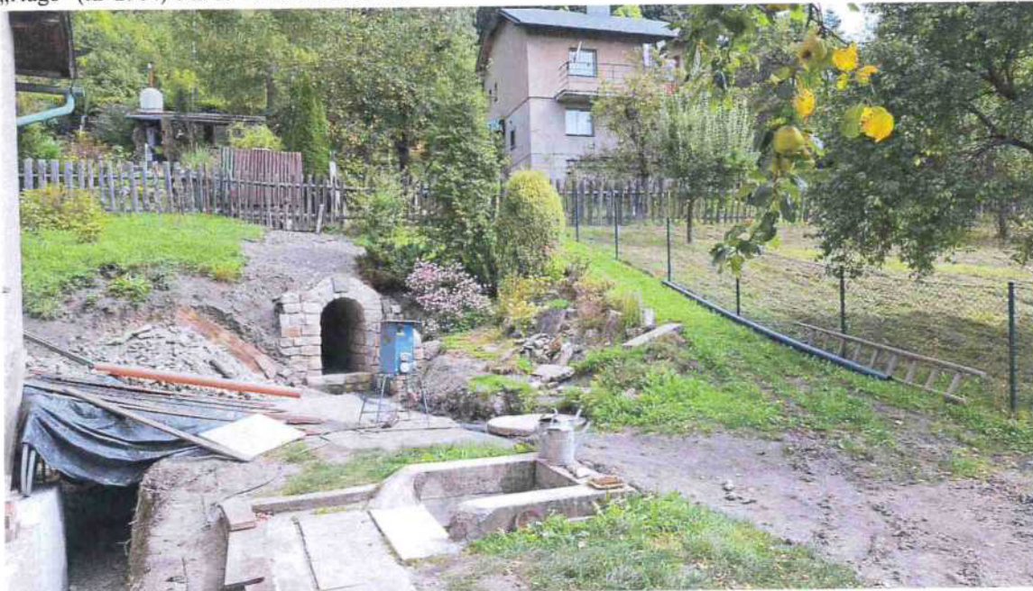
Stav na lokalitě během KD č. 5, takřka hotová báňská část, viditelný vliv na podloží (suchá základová spára)
