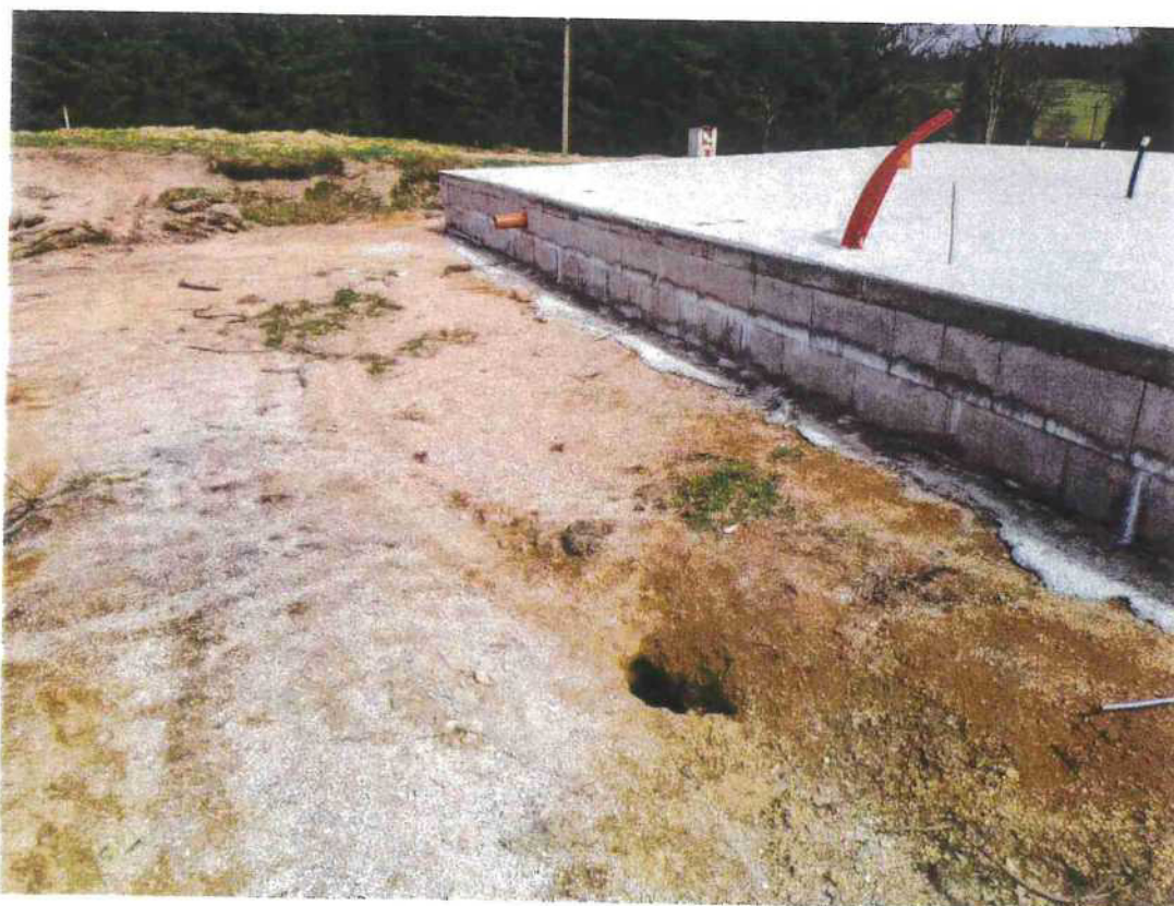
Foto č. 2 pokles (propad) terénu Přebuz (p. č. 785/10) po přejetí místa nákladním vozidlem
