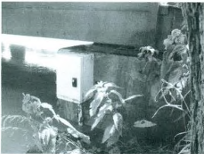
Obrázek 3: Chybná instalace jednotky, spodní část se nachází evidentně v dosahu záplavy; zdroj: výše uvedená metodická příručka MŽP
