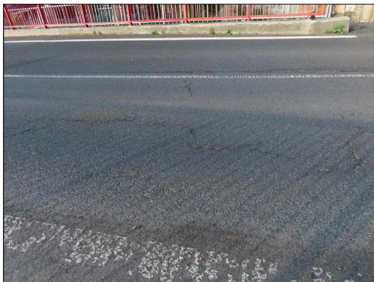
Pravá strana nad OP2 Vozovka - všesměrné trhliny
