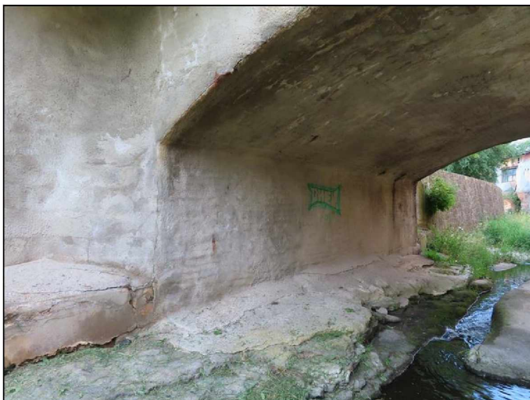
Pohled na OP1 zprava Projevy zatékání v okraji klenebního pásu
