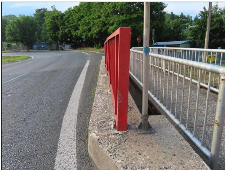
Levá strana Zábradlí - mírné vychýlení posledního sloupku
