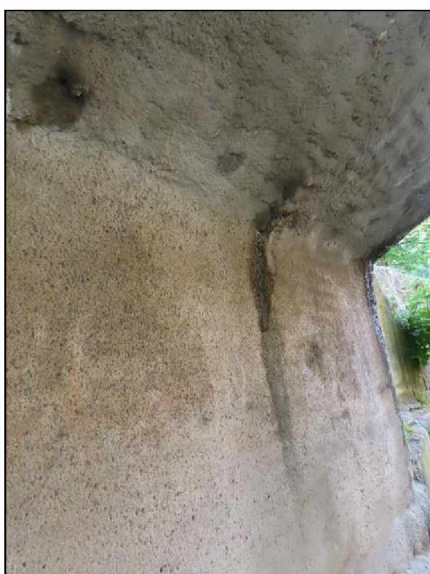
Pohled na OP1 LS Projevy průsaků
