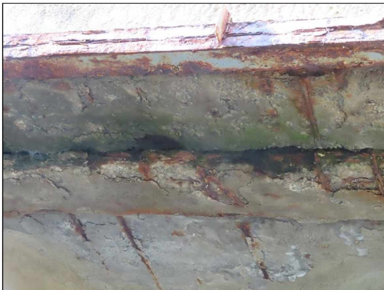
Pohled nad OP1 zprava NK- pravé klínovité rozšíření- rozpad betonu
