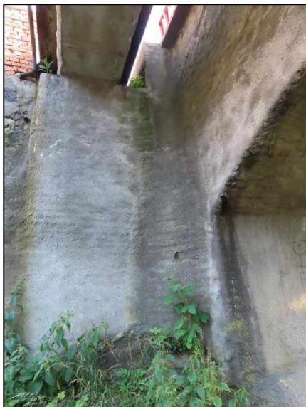
Pohled na OP2 zleva Průsaky podél svislé hrany a na přechodu klenby a dříku
