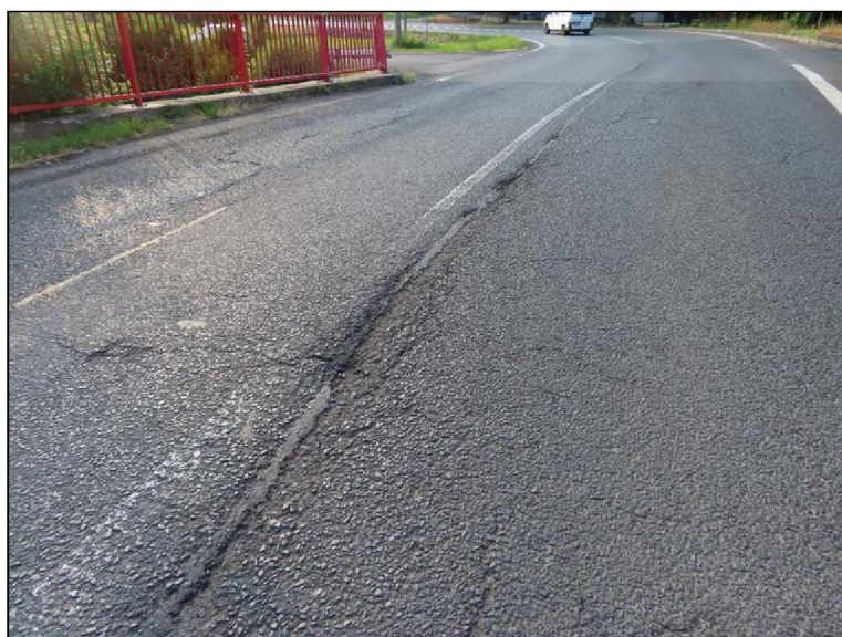
Vozovka proti směru staničení Otevírající se středová spára, kaverny podél ní.
