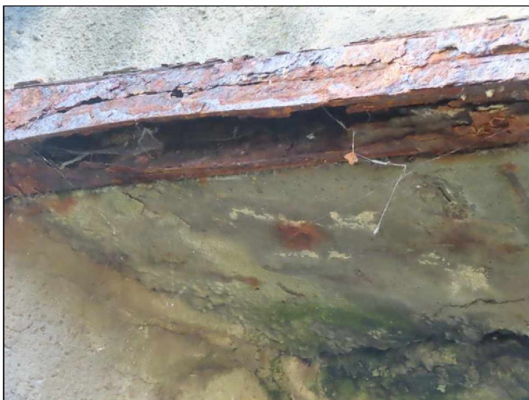
Pohled nad OP1 zprava NK- pravé klínovité rozšíření Překorodování krajního profilu
