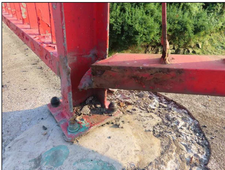
Pravá strana Zábradlí- poškození od nárazu- vylomení dolního madla Mrázový rozpad římsy
