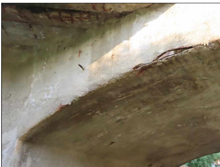
Pohled nad OP1 zprava Trhlina v hraně - odpadnutí torkretu
