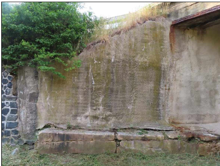
Pohled na křídlo OP1 zprava Rozpad betonu u paty
