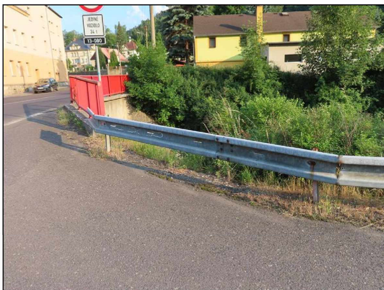
Pravá strana před OP1 Svodidlo - nalomené Nevhodné napojení svodnice
