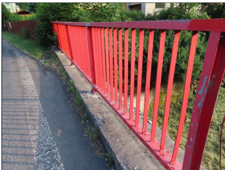
Pravá strana Zábradlí- poškození Mrázový rozpad římsy
