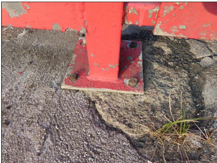
Levá strana Zábradlí- koroze kotev
