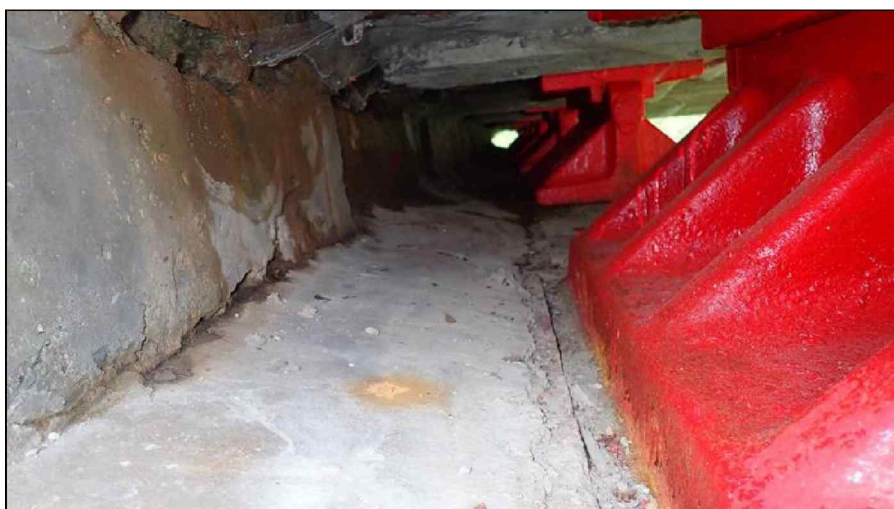
Známky zatékání na ZZ u OP2. Degradovaný beton ZZ OP2
