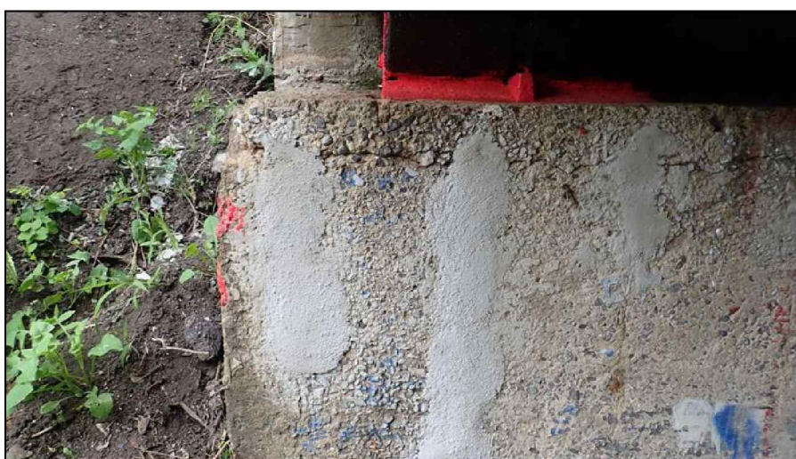
Degradující beton ÚP. Zasanované odhalená výztuž ÚP
