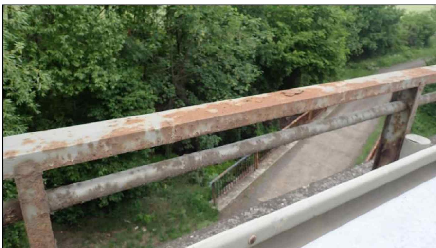
Celoplošná koroze zábradlí
