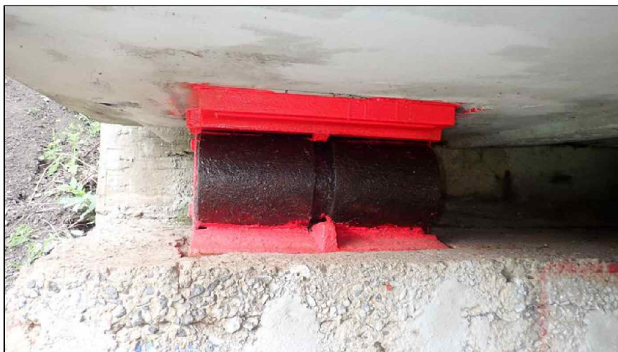
Nově ošetřená ložiska na OP1. Degradující beton ÚP. Zasanované odhalená výztuž ÚP
