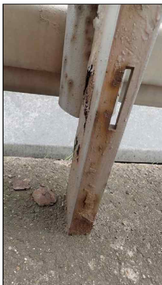
Hlubková koroze slouků svodidel. Opatření: předsazené bet. svodidlo
